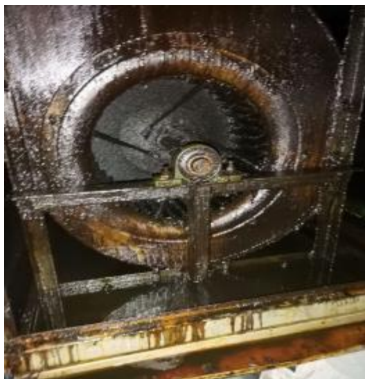
员工厨房风机清洗前 1
