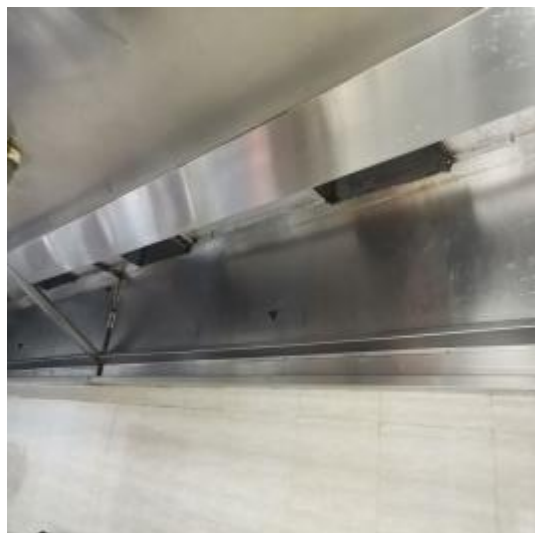
中厨房烟罩清洗后
