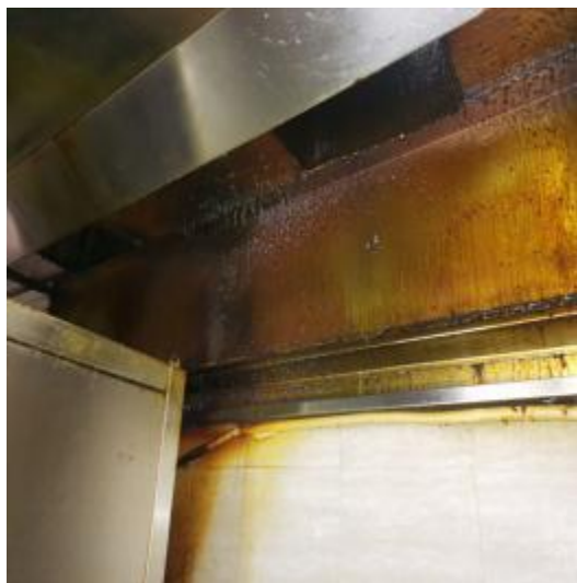
西厨房烟罩清洗前 2
