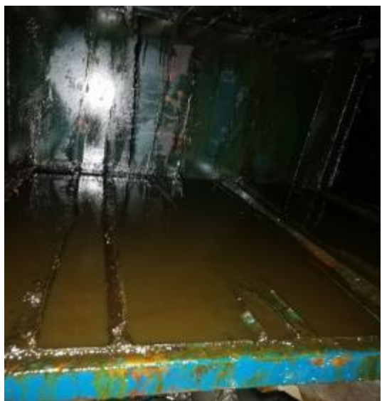
员工厨房净化器机箱清洗前
