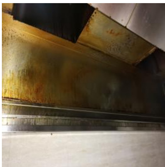
西厨房烟罩清洗前 1
