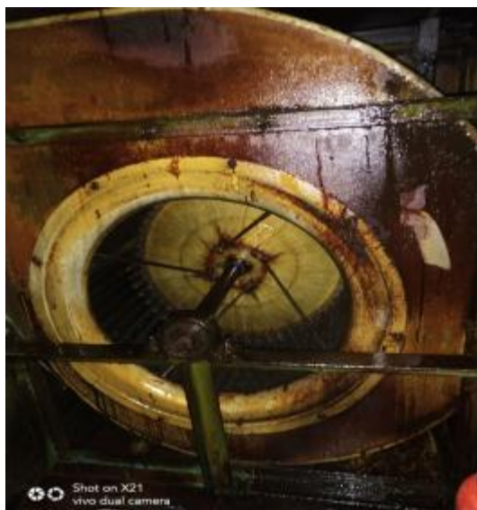
宴会厨房风机清洗前 2
