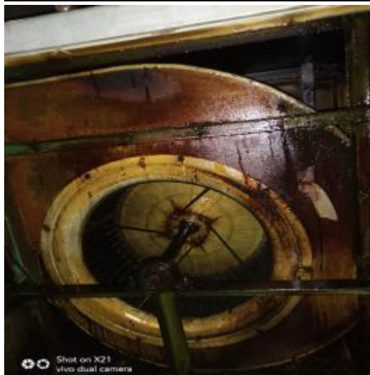
宴会厨房风机清洗前 1
