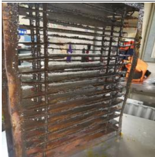
员工厨房净化器清洗前
