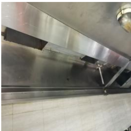
中厨房烟罩清洗后
