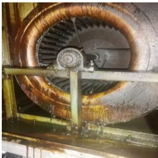
中厨房风机清洗前
