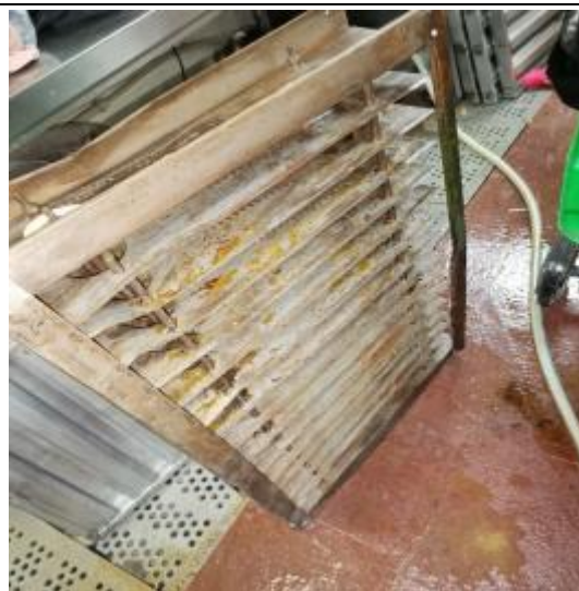
员工厨房净化器清洗后
