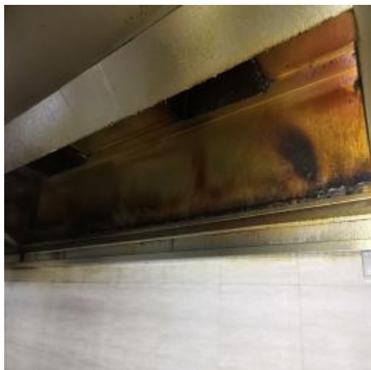
中厨房烟罩清洗前
