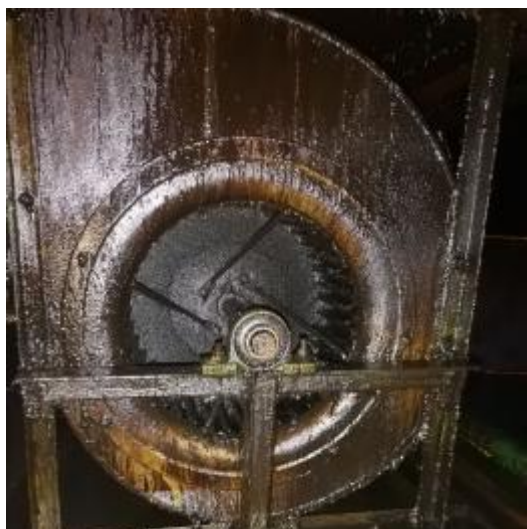
员工厨房风机清洗前 2
