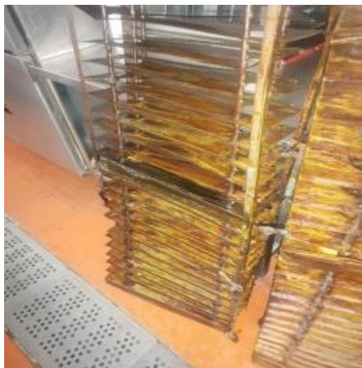
西厨房净化器清洗前
