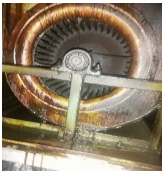
西厨房风机清洗前 2
