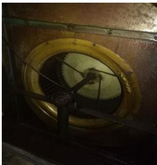
西厨房风机清洗前 1
