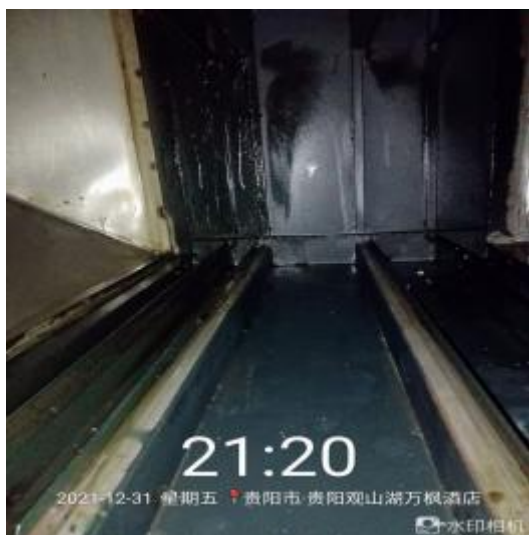
净化器机箱清洗前
