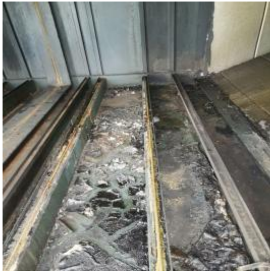
净化器机箱清洗前
