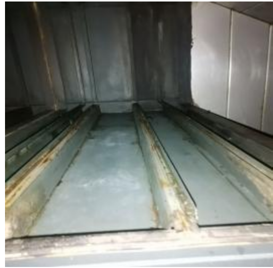
净化器机箱清洗后
