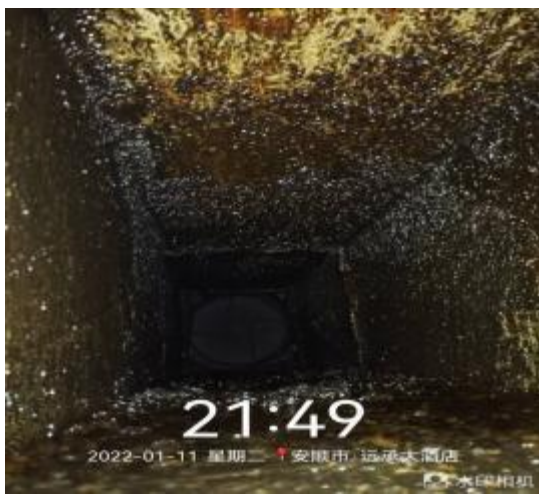
风机管道清洗前
