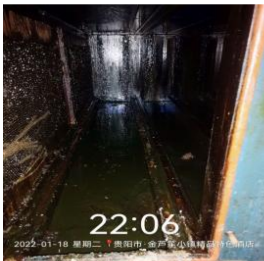
净化器机箱清洗前
