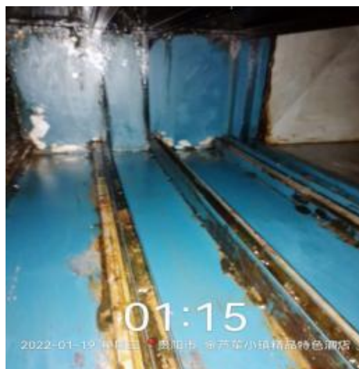
净化器机箱清洗后
