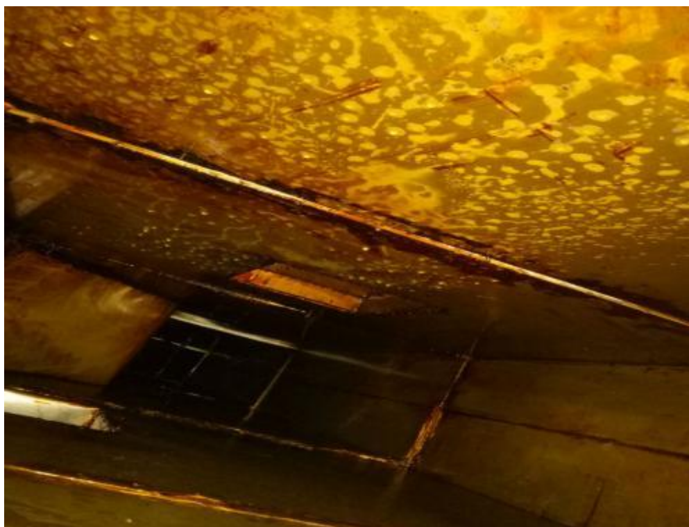
油烟内部管道清洗前
