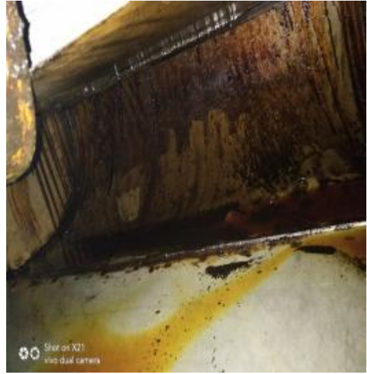
中厨房管道清洗前 2
