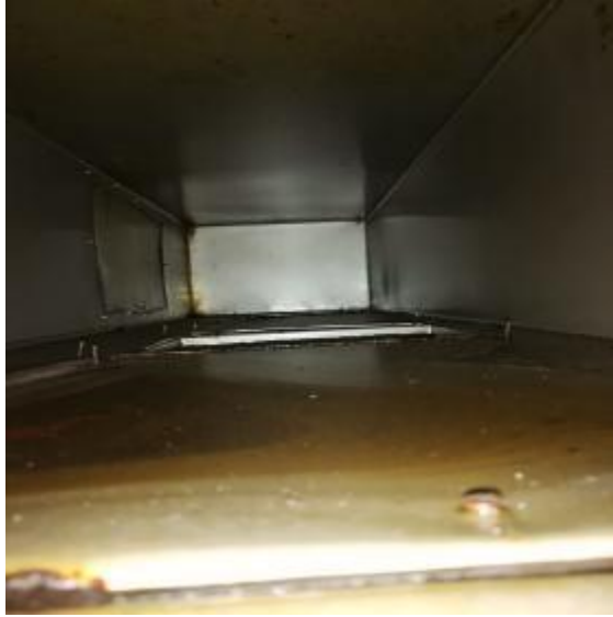
烧腊厨房烟罩清洗前 2
