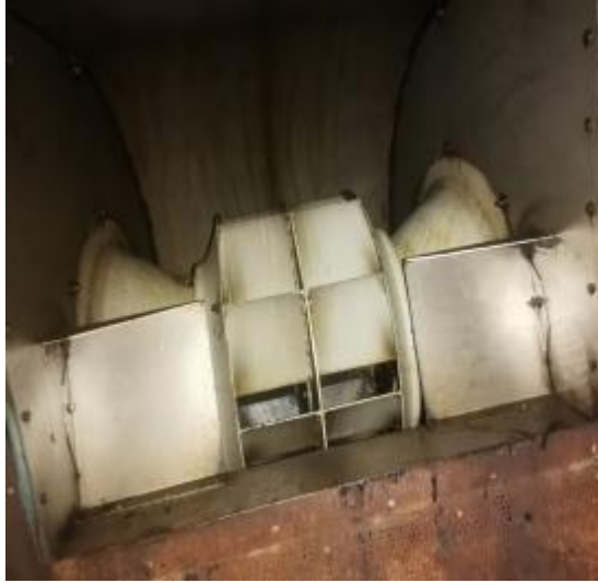
楼顶风机清洗前 1
