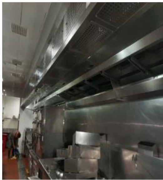
会所厨房烟罩清洗中
