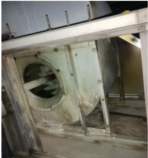
楼顶风机清洗前 3
