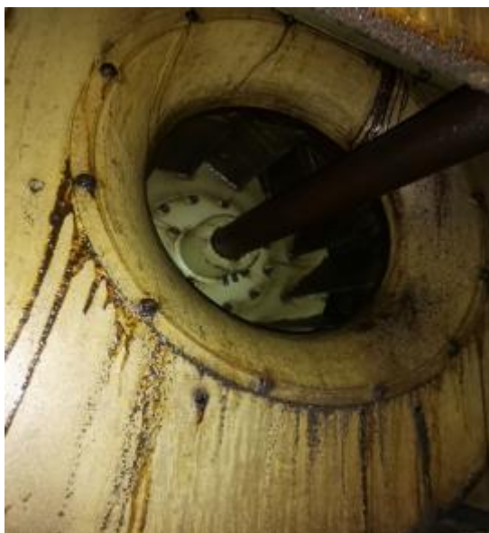
楼顶风机清洗前 2
