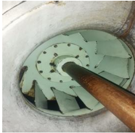
楼顶风机清洗前 3
