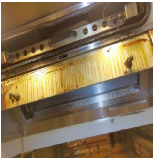
西厨房烟罩清洗前
