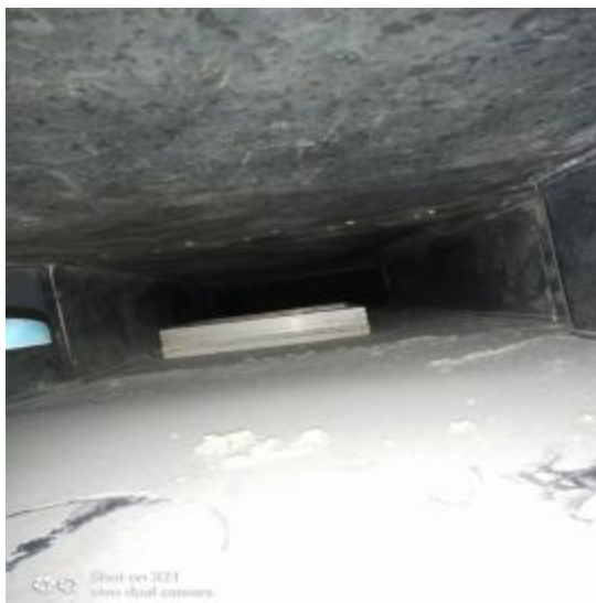
洗衣房管道清洗前 2
