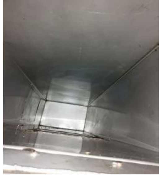
烧腊厨房烟罩清洗前 2
