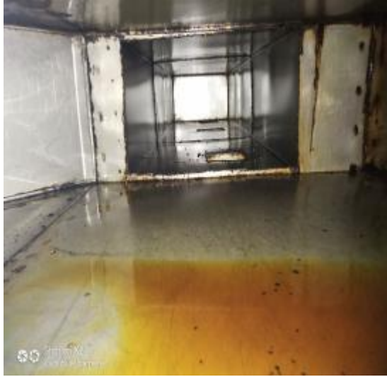
中厨房管道清洗前3
