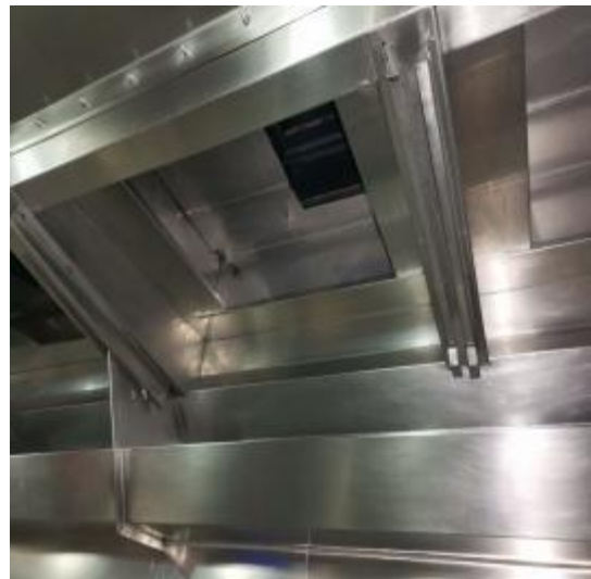
宴会厨房烟罩清洗后
