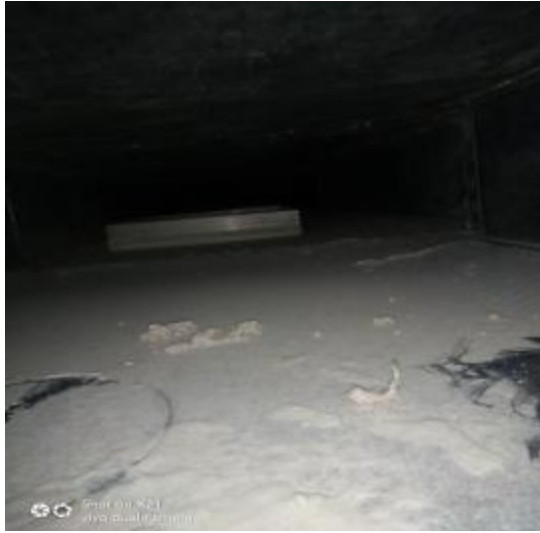
洗衣房管道清洗前 1
