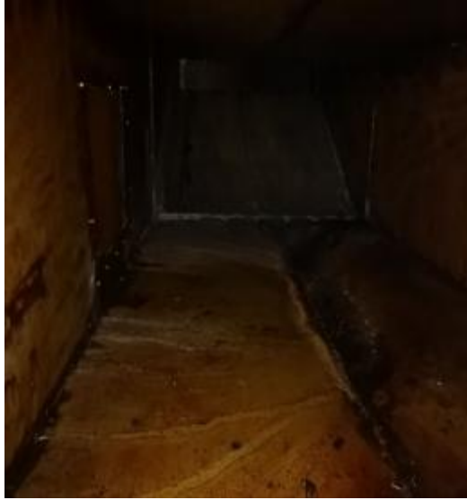
西厨房管道清洗前
