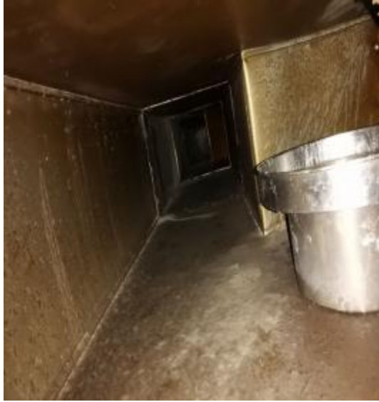
宴会厨房管道清洗前
