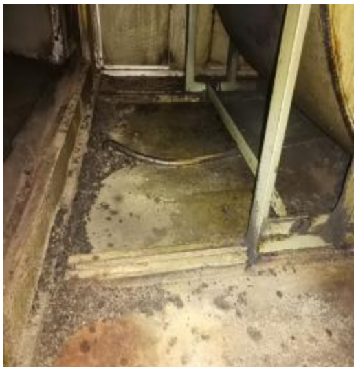
楼顶风机清洗前 4
