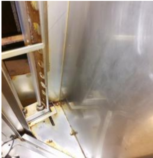
西厨房烟罩清洗前 2
