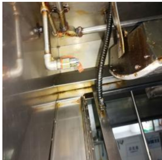
咖啡厅厨房烟罩清洗后
