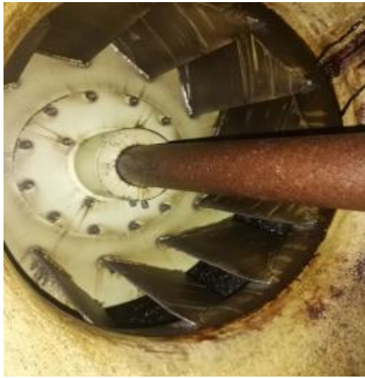
楼顶风机清洗前 3
