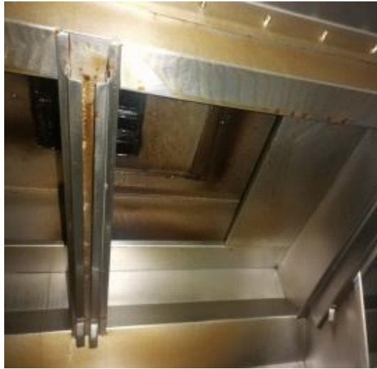
中厨房烟罩清洗前
