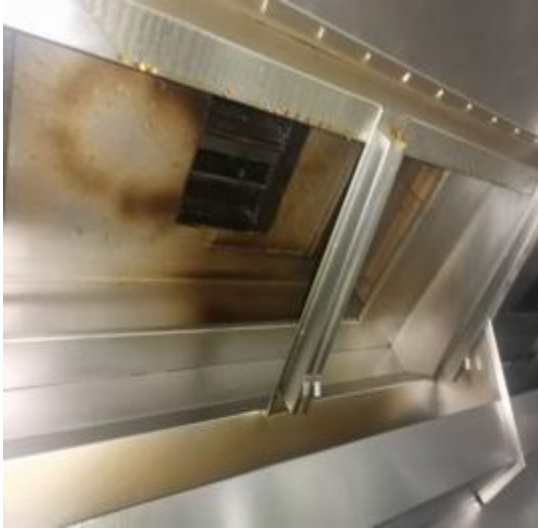
中厨房烟罩清洗前
