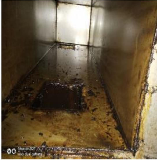
中厨房管道清洗前 1
