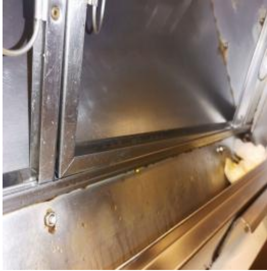
西厨房烟罩清洗前 1
