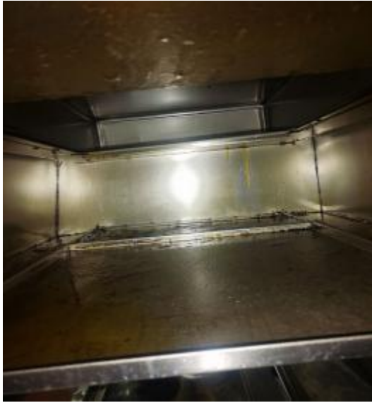
中厨房管道清洗前
