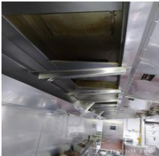
中厨房烟罩清洗前
