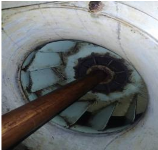
楼顶风机清洗前 4
