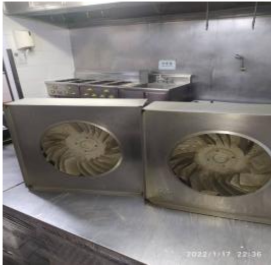
热辣厨房风扇清洗前
