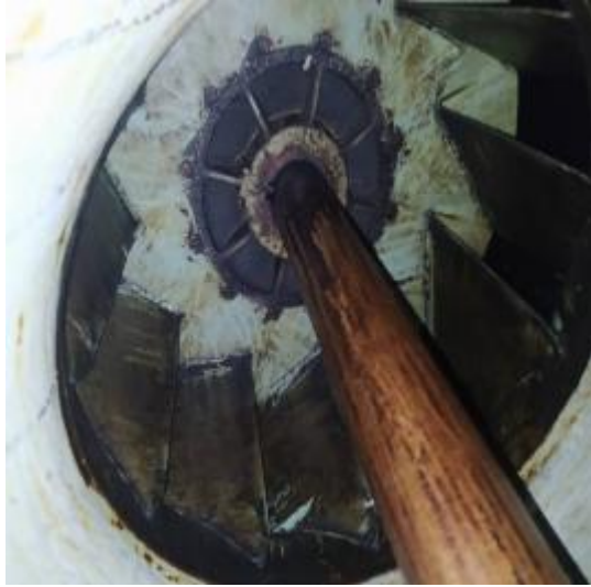
楼顶风机清洗前 3
