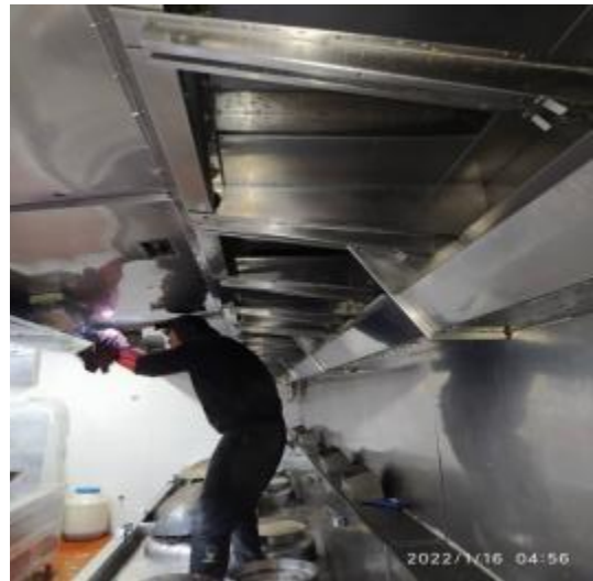
中厨房烟罩清洗中
