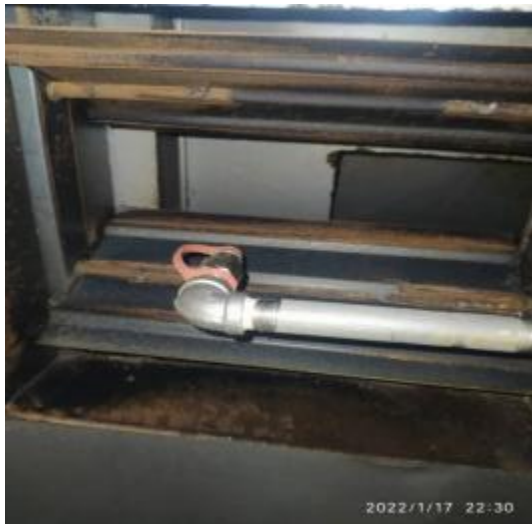
热辣厨房管道清洗前
