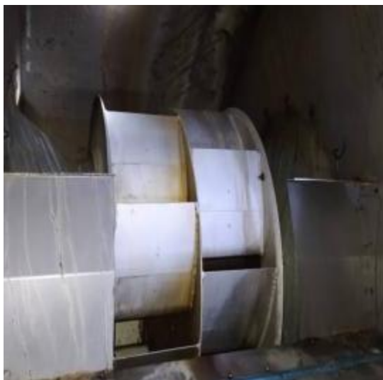
楼顶风机清洗前 2
