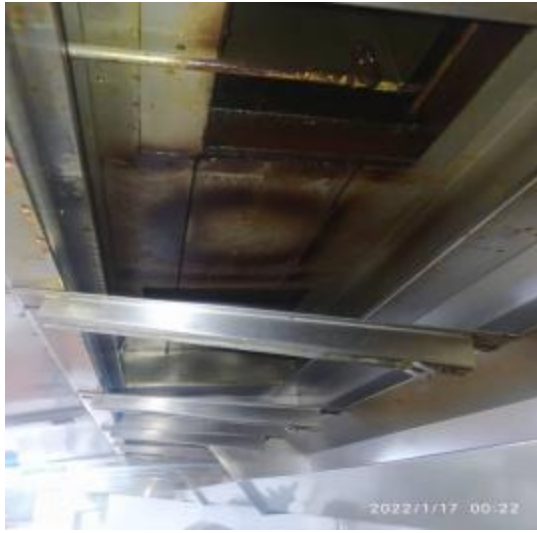
工厨房烟罩清洗前
