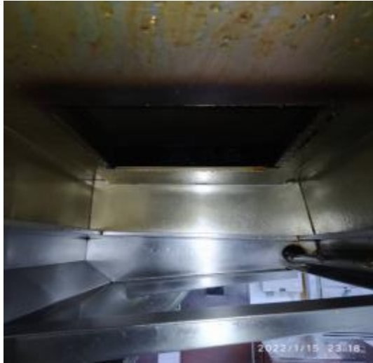
中厨房烟罩清洗前
