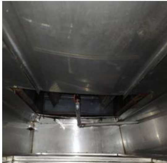
宴会厨房烟罩清洗后
