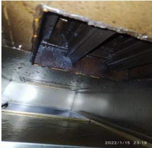
中厨房烟罩清洗前
