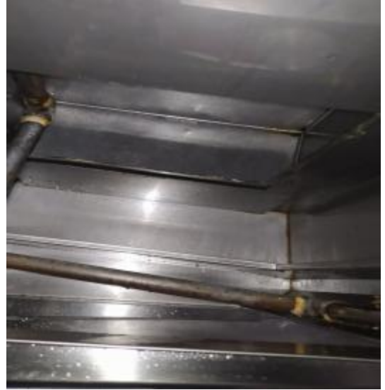
宴会厨房管道清洗前
