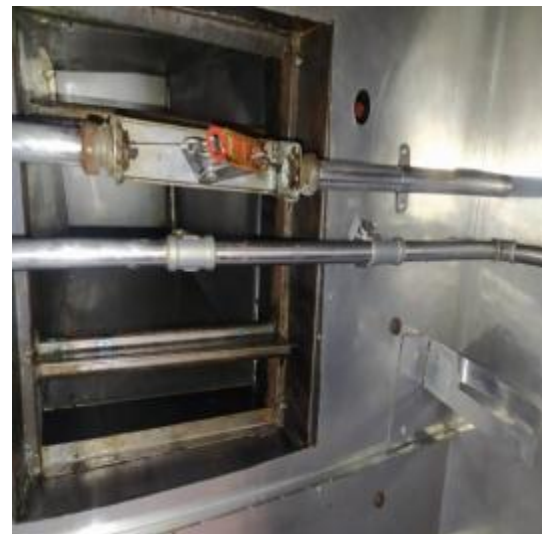
咖啡厅厨房烟罩清洗后
