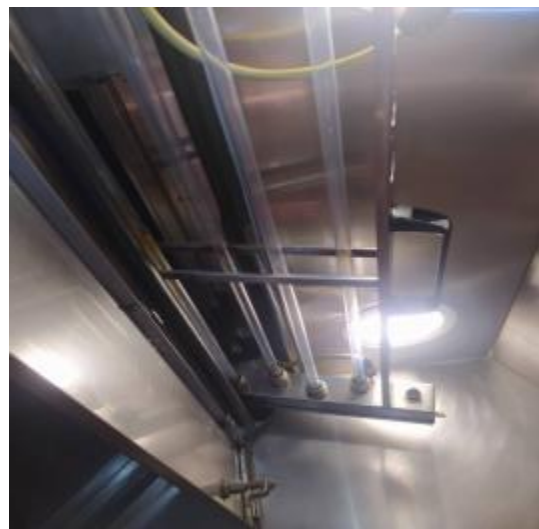
咖啡厨房管道清洗后
