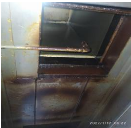
员工厨房管道清洗前
