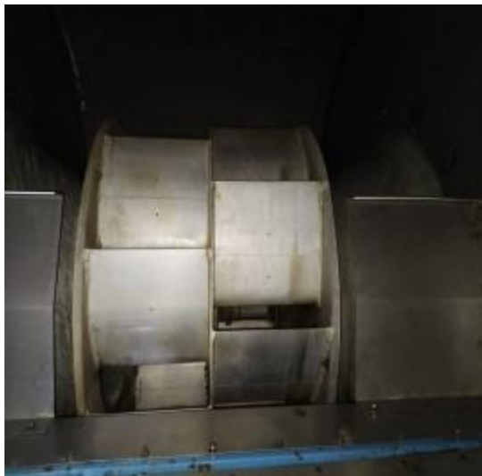
楼顶风机清洗前 1
