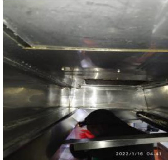
中厨房烟罩清洗中
