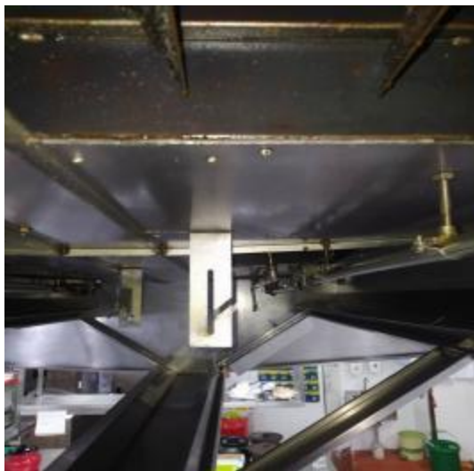
咖啡厨房管道清洗前
