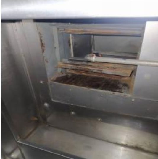
烧腊厨房管道清洗前
