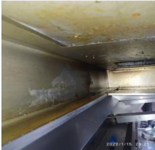
中厨房烟罩清洗前
