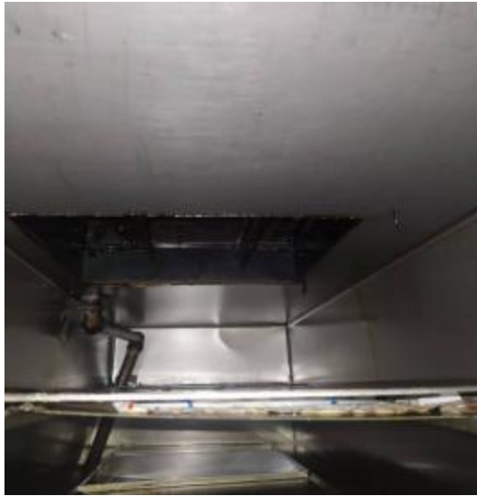
宴会厨房管道清洗前
