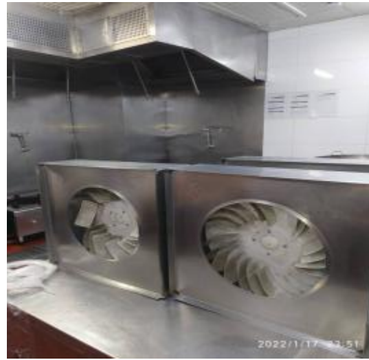
热辣厨房风扇清洗后
