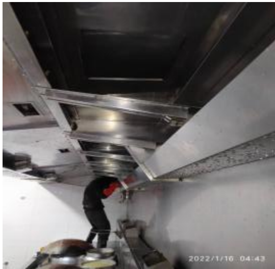
中厨房烟罩清洗中
