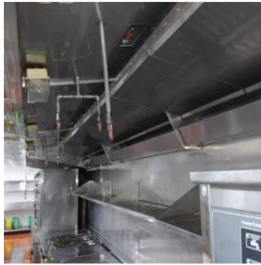
宴会厨房烟罩清洗后
