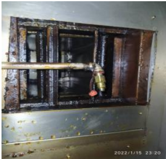
中厨房管道清洗前
