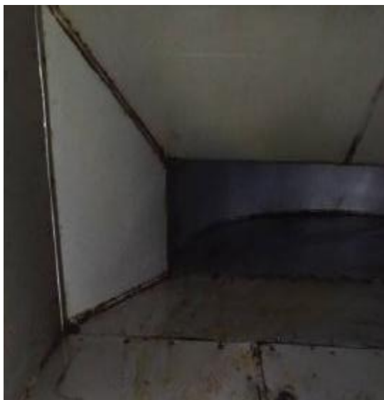
宴会厨房主管道清洗前
