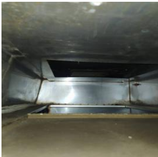
烧腊厨房管道清洗前
