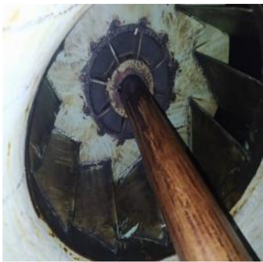
楼顶风机清洗前 3
