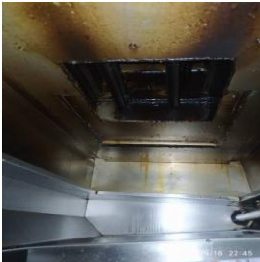
中厨房烟罩清洗前
