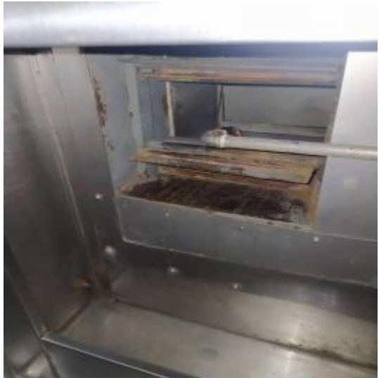
烧腊厨房管道清洗前
