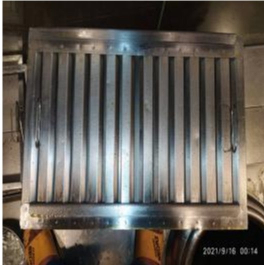
咖啡厅厨房挡板清洗前
