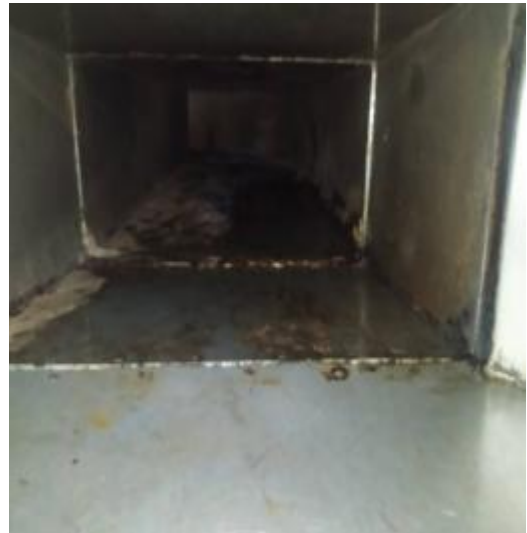
员工厨房主管道清洗后
