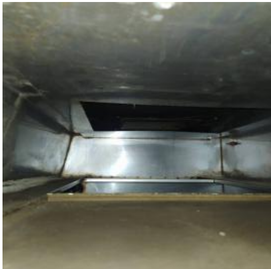
烧腊厨房管道清洗前
