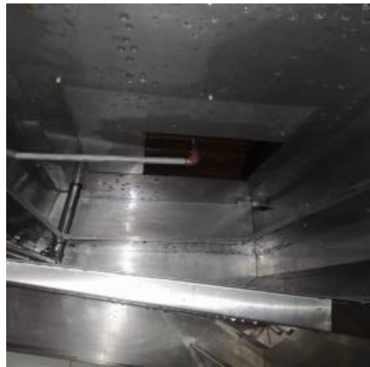
烧腊厨房管道清洗后
