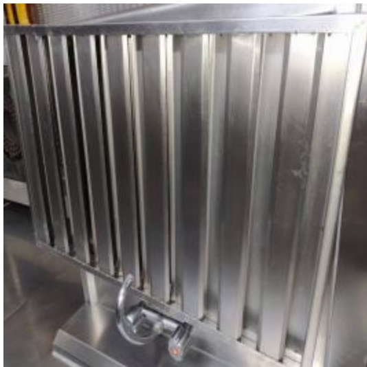
热辣厨房防火板清洗前
