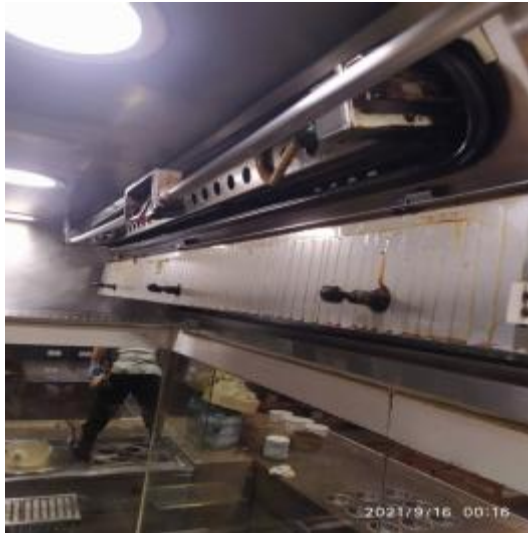
咖啡厨房明档烟罩清洗前
