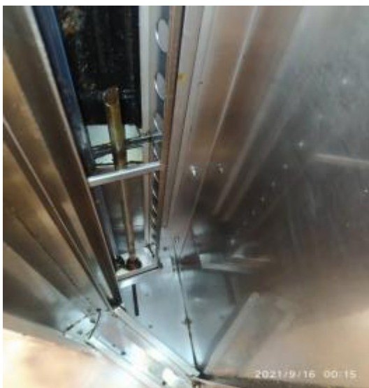
咖啡厨房明档烟罩清洗前
