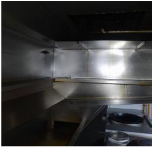
工厨房烟罩清洗前
