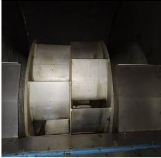
楼顶风机清洗前 1
