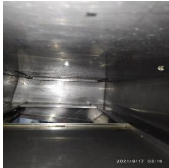
中厨房烟罩清洗后
