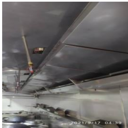
中厨房防火板清洗后
