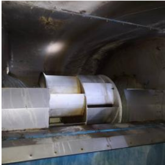
楼顶风机清洗前 2
