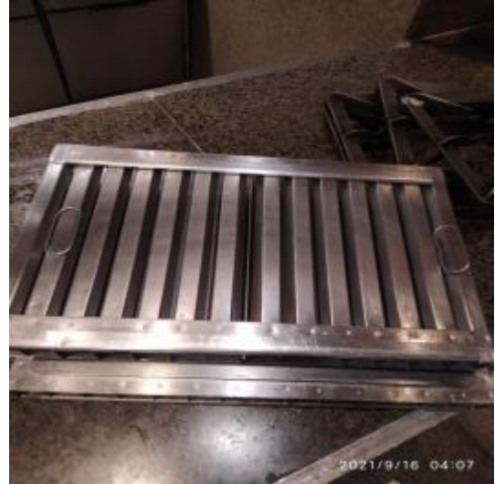
咖啡厅厨房挡板清洗后
