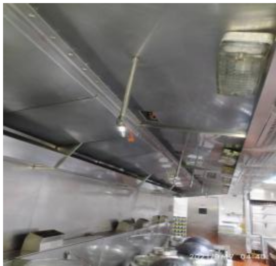
中厨房烟罩清洗后
