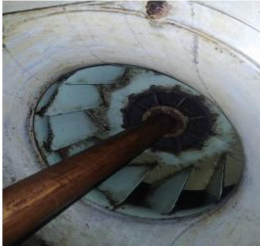
楼顶风机清洗前 4
