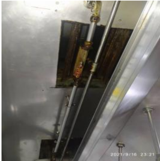
咖啡厅烟罩灯管清洗前
