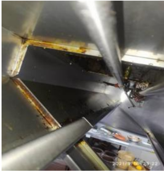
咖啡厅厨房管道清洗前
