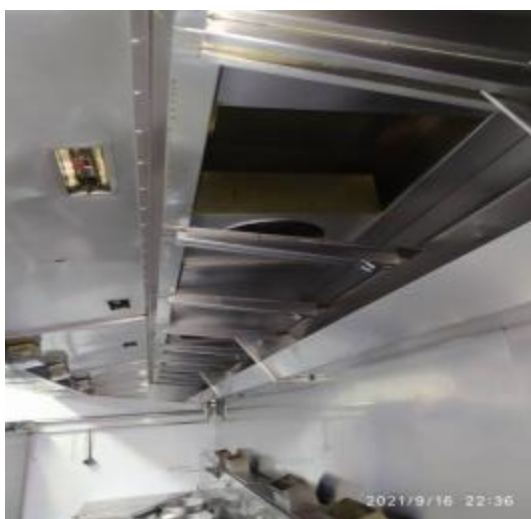
中厨房烟罩清洗前
