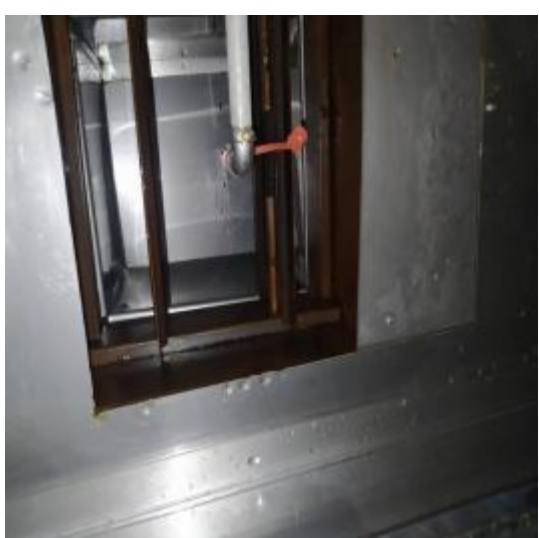
烧腊厨房管道清洗后
