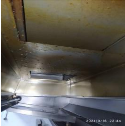
中厨房烟罩清洗前
