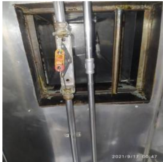
中厨房烟罩清洗后
