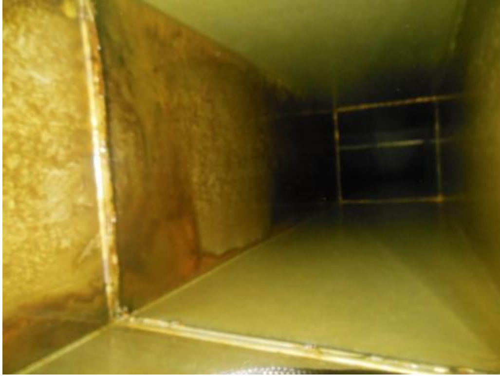
油烟内部管道清洗前 1
