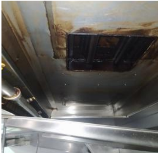
中厨房烟罩清洗前
