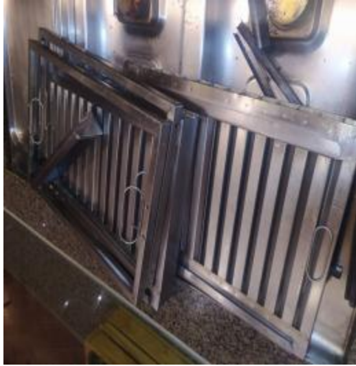
咖啡厅厨房挡板清洗前
