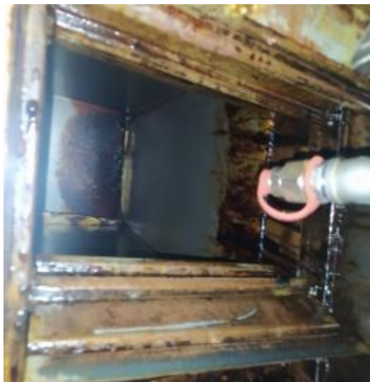
咖啡厅厨房管道清洗前
