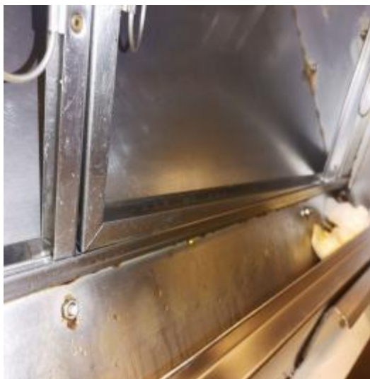
西厨房烟罩清洗前
