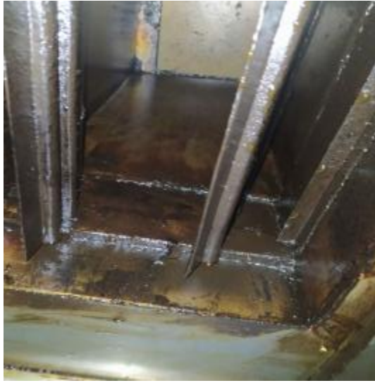
中厨房烟罩清洗前
