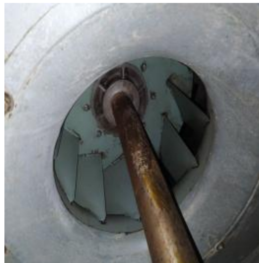
楼顶风机清洗前 3
