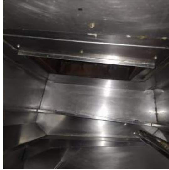
中厨房烟罩清洗后
