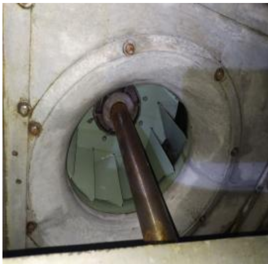
楼顶风机清洗前 3
