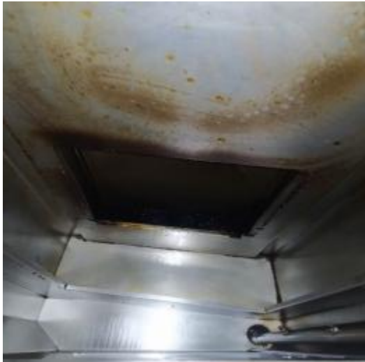
西厨房烟罩清洗前
