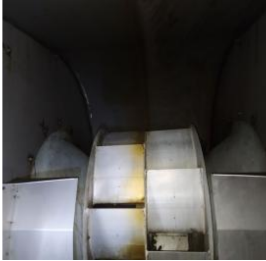
楼顶风机清洗前 1
