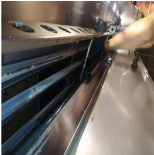
西厨房烟罩清洗中
