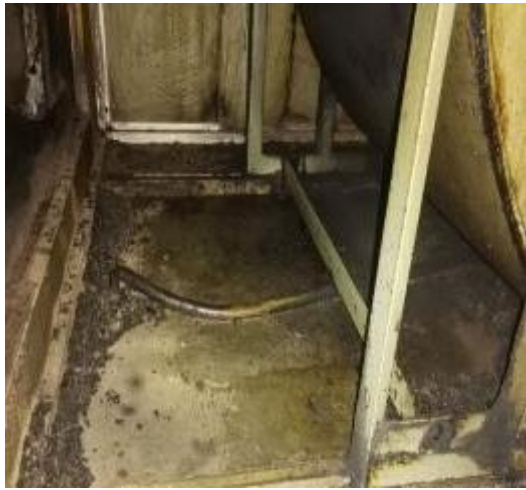
楼顶风机机箱清洗前 4
