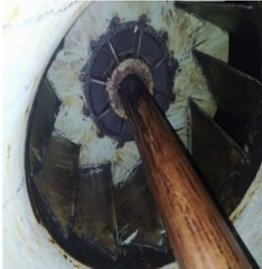
楼顶风机清洗前 2
