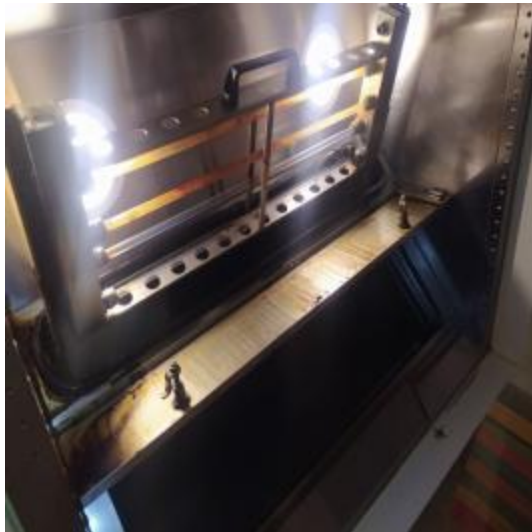
咖啡厅烟罩灯管清洗前
