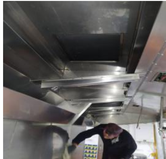
中厨房烟罩清洗中
