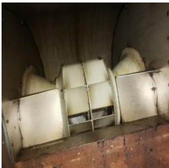
楼顶风机清洗前 1
