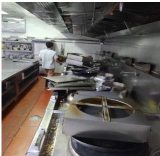
中厨房烟罩清洗中
