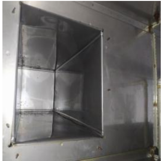
烧腊厨房管道清洗后
