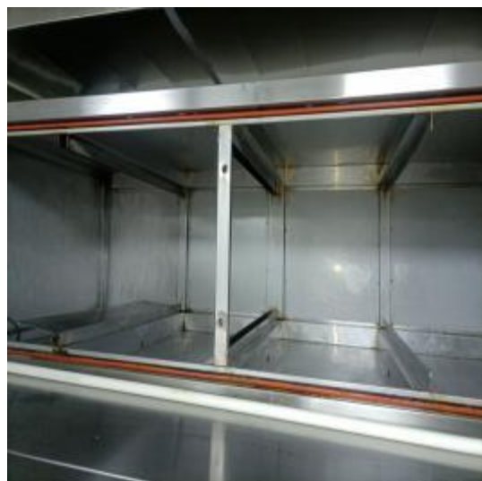
净化器机箱清洗后 2
