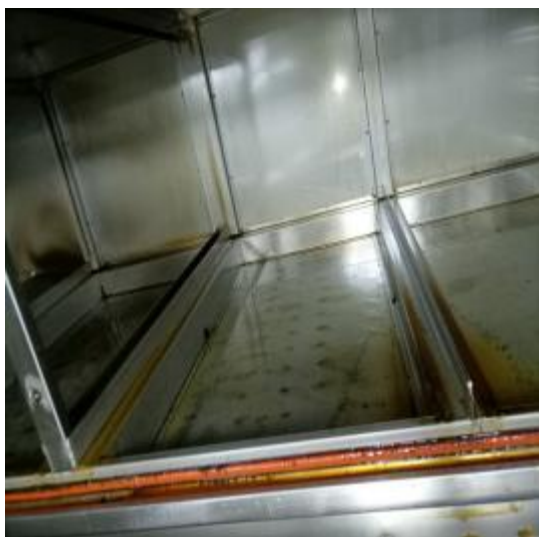
净化器机箱清洗前 2
