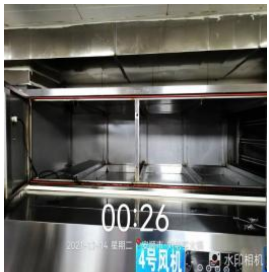
净化器机箱清洗后 2
