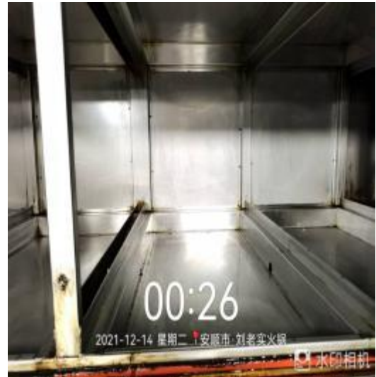
净化器机箱清洗后 1
