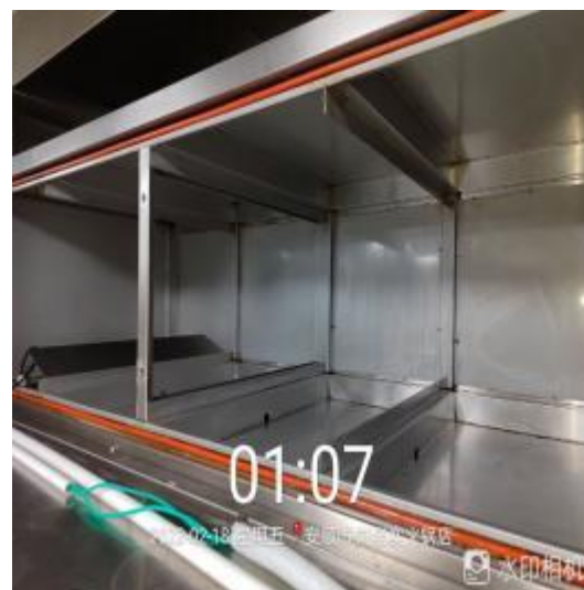
净化器机箱清洗后
