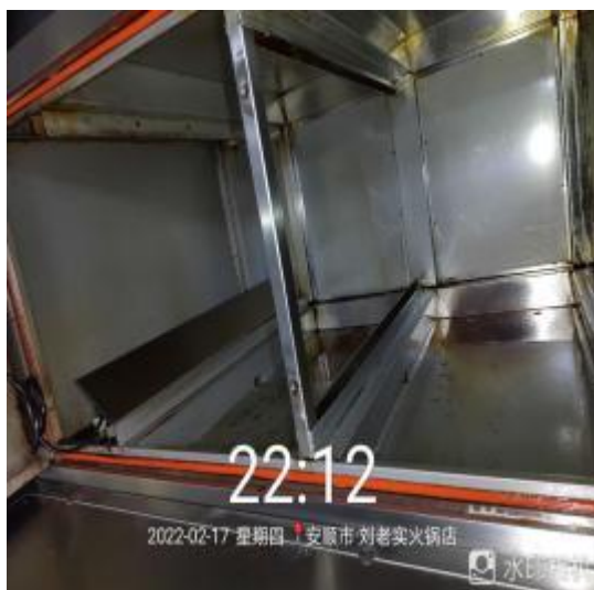
净化器机箱清洗前
