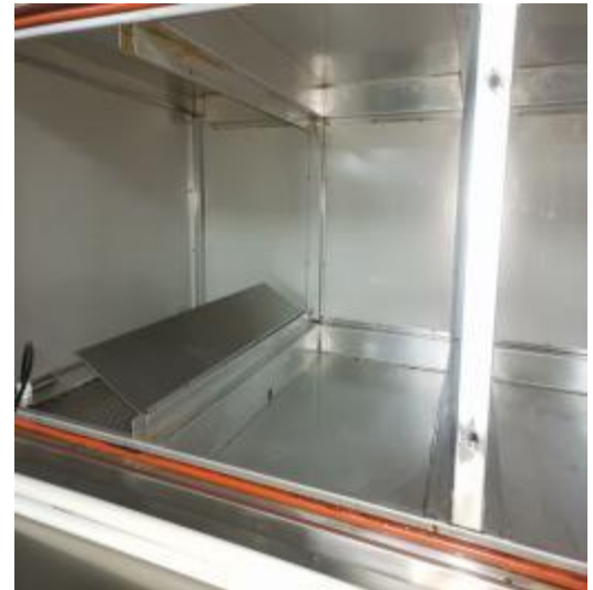
净化器机箱清洗后 2
