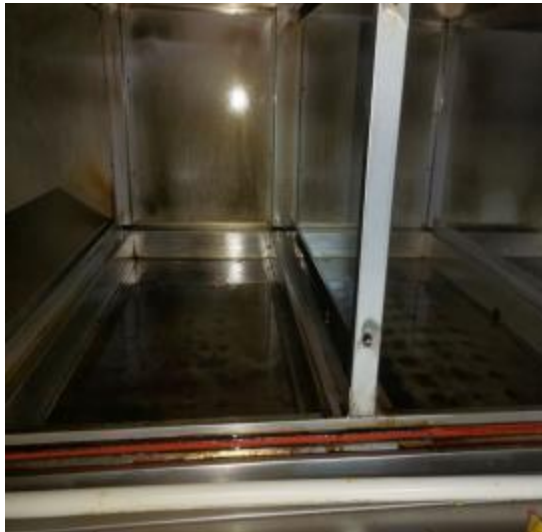
净化器机箱清洗前 2
