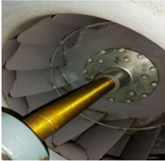
中厨房风机清洗前
