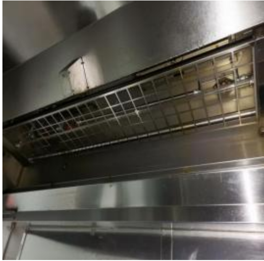
西厨房烟罩清洗前
