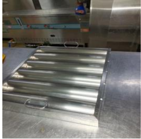
员工厨房防火板清洗后
