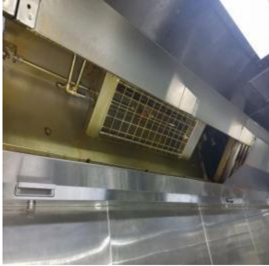
中厨房烟罩清洗前 1
