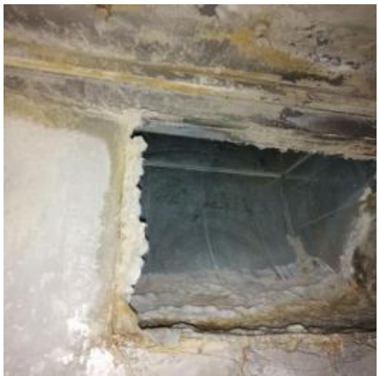
洗衣房管道清洗前
