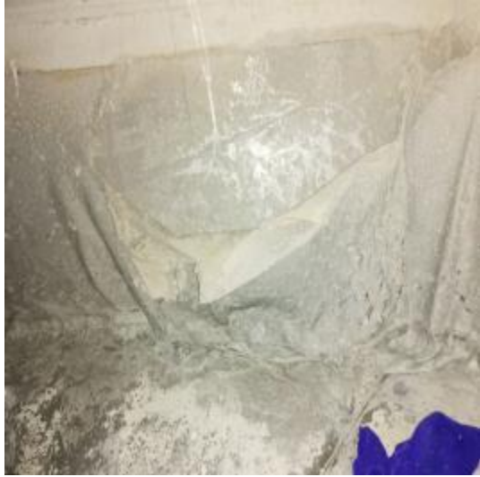
洗衣房管道清洗前 2
