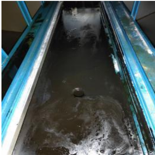
净化器机箱清洗前
