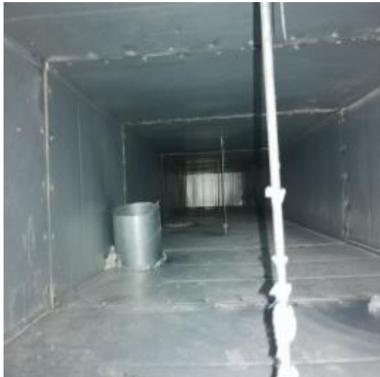
洗衣房管道清洗前 3
