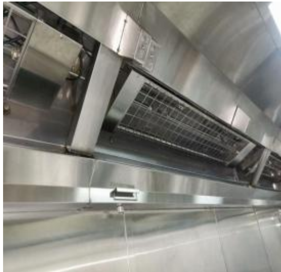
宴会厨房烟罩清洗后 1
