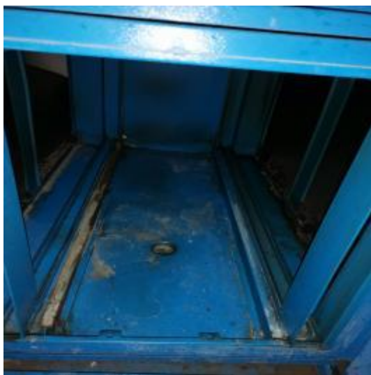
净化器机箱清洗前
