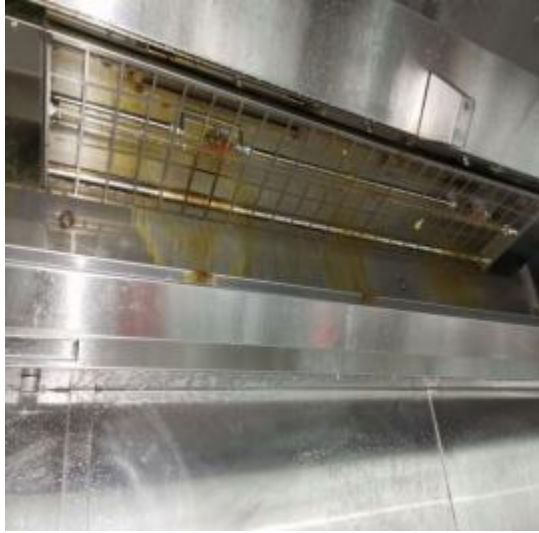
西厨房烟罩清洗前
