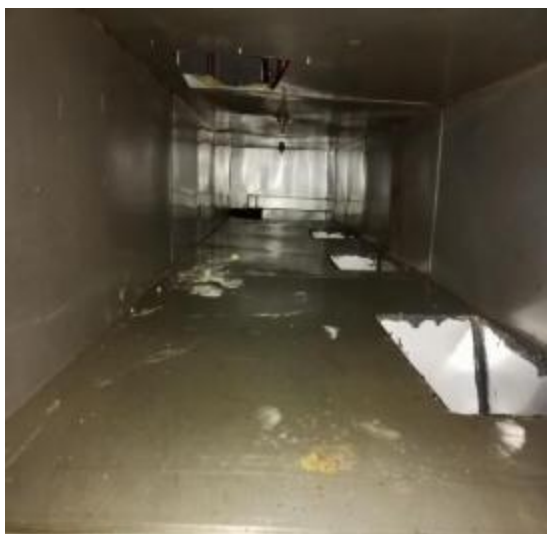
员工厨房管道清洗前
