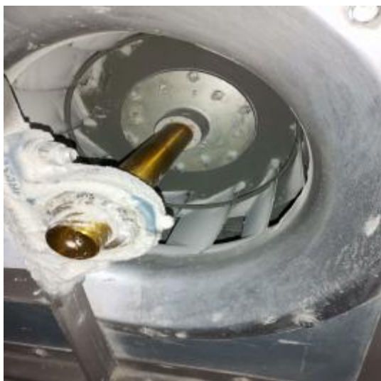
洗衣房风机清洗前
