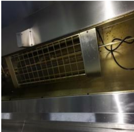
中厨房烟罩清洗前 2
