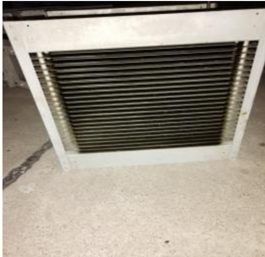
员工厨房净化器清洗前
