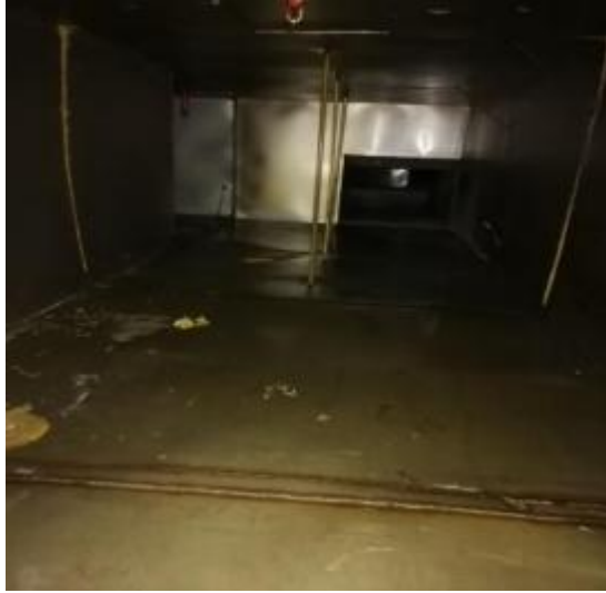
中厨房管道清洗前
