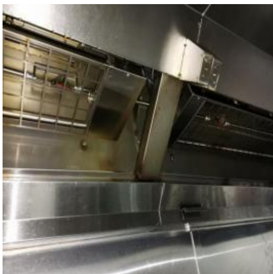
宴会厨房油槽清洗前 2
