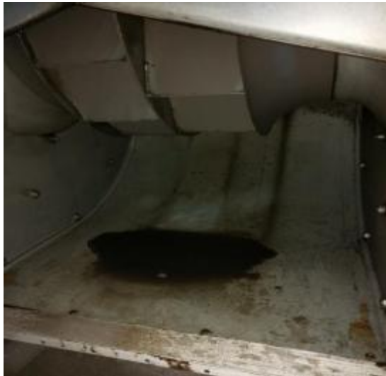
楼顶风机清洗前 2
