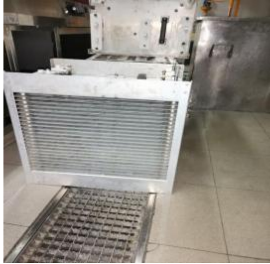
宴会厨房净化器清洗后
