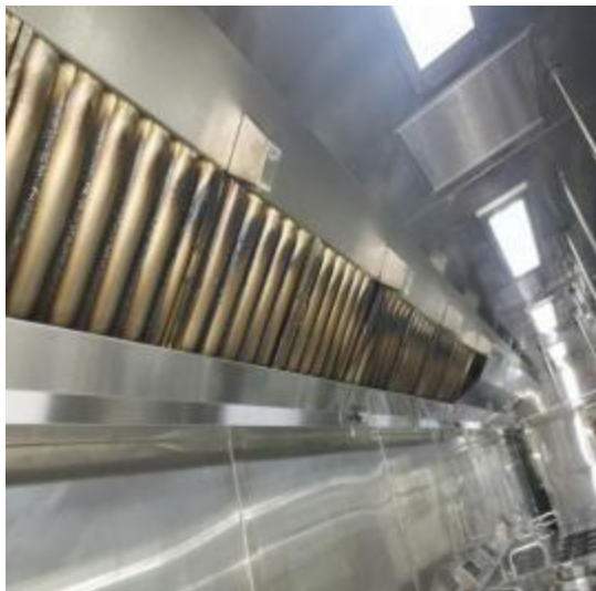
中厨房烟罩清洗前 3
