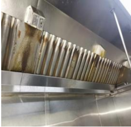
员工厨房防火板清洗前
