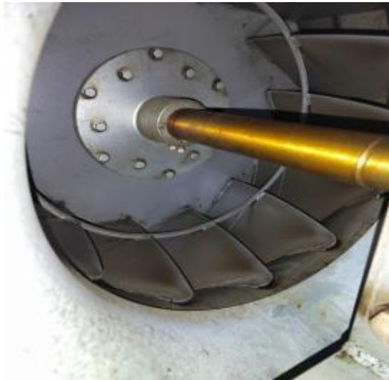
楼顶风机清洗前 1
