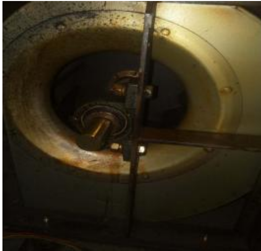
楼顶风机清洗前 2
