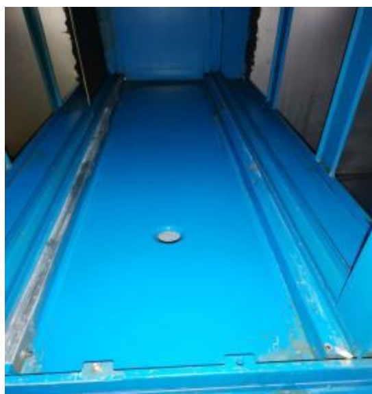
净化器机箱清洗后
