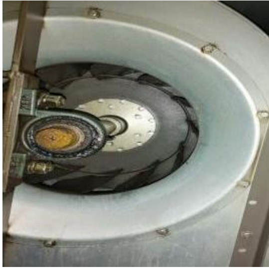
宴会厨房风机清洗前
