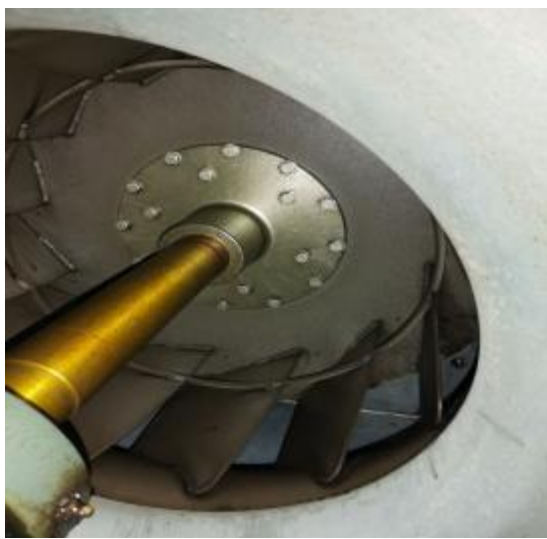
中厨房风机清洗前
