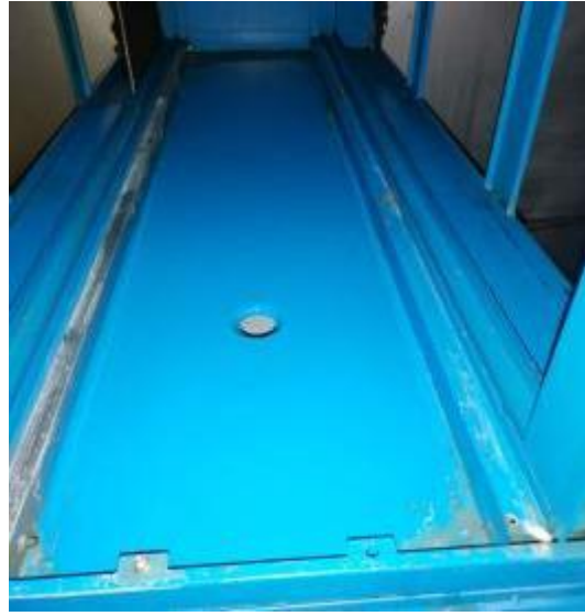
净化器机箱清洗后
