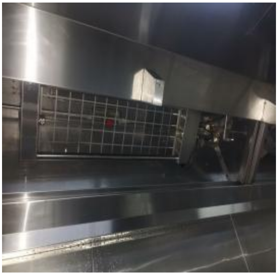
中厨房烟罩清洗后 2
