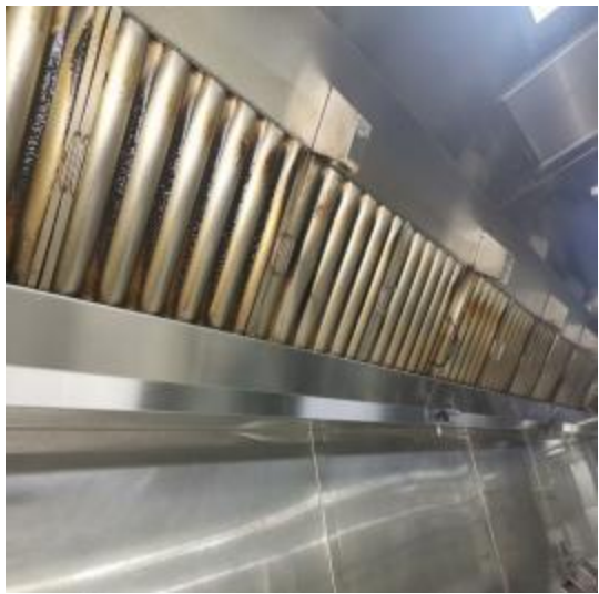
中厨房烟罩清洗前 2
