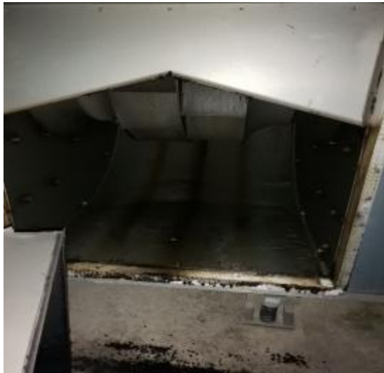
楼顶风机清洗前 1
