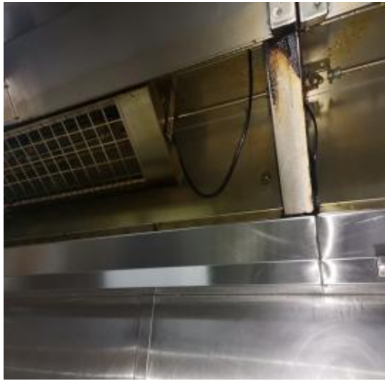
中厨房烟罩清洗前 1
