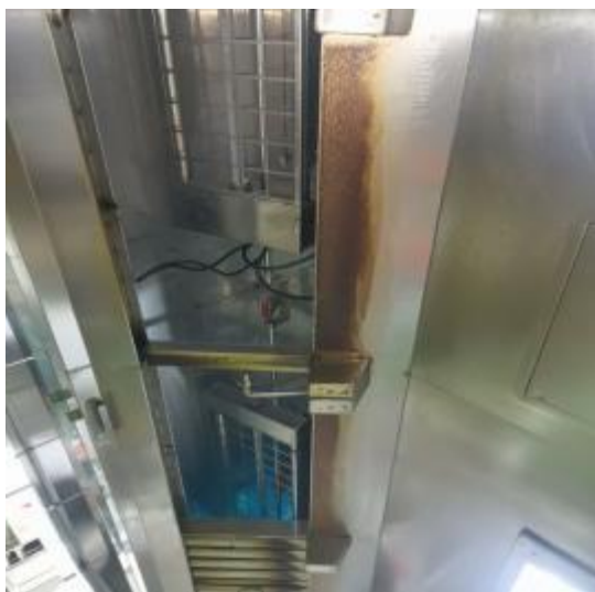
西厨房烟罩清洗前
