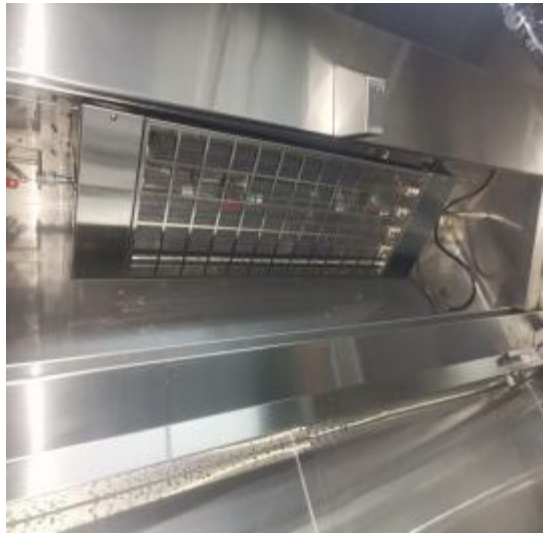
中厨房烟罩清洗后 1
