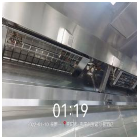
中厨房烟罩清洗后 1
