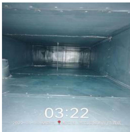
洗衣房管道清洗后 3
