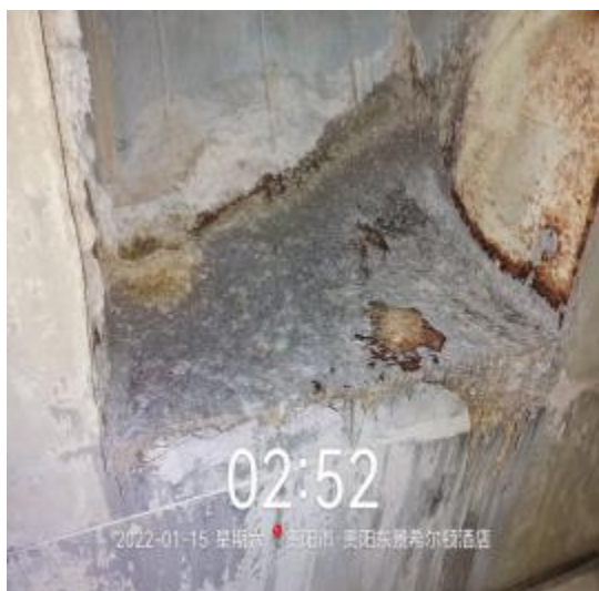
洗衣房管道清洗前 2
