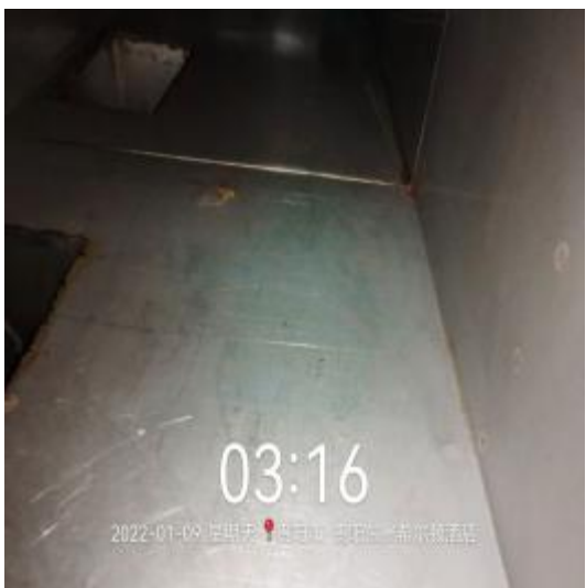
员工厨房管道清洗后
