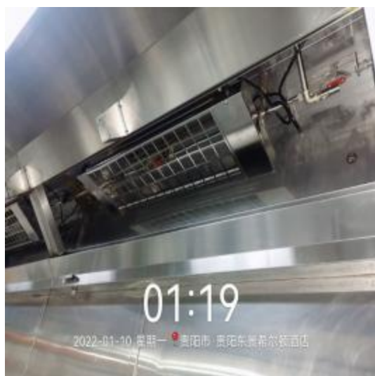
中厨房烟罩清洗后 2
