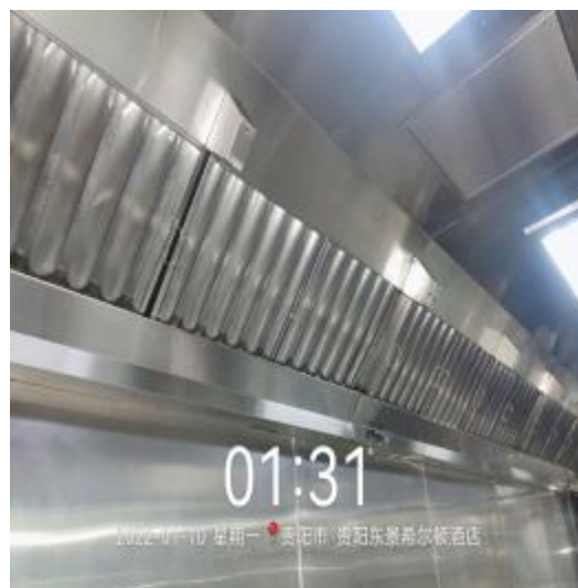
中厨房烟罩清洗后 3
