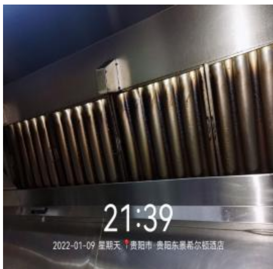
中厨房烟罩清洗前 3
