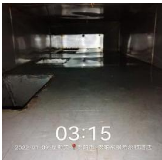
员工厨房管道清洗后
