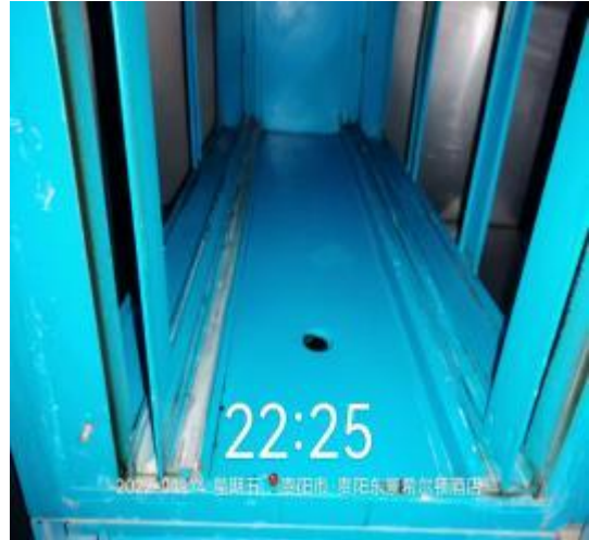
净化器机箱清洗后
