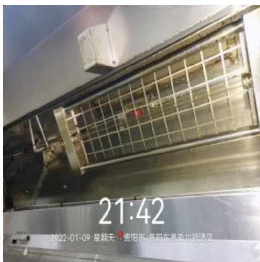
中厨房烟罩清洗前 2
