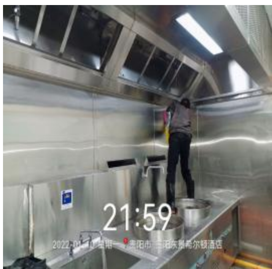
中厨房烟罩清洗前 4
