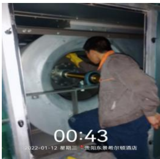
宴会厨房风机清洗前
