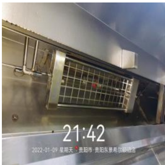
中厨房烟罩清洗前 1
