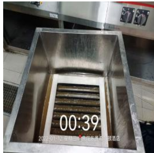
宴会厨房净化器清洗中
