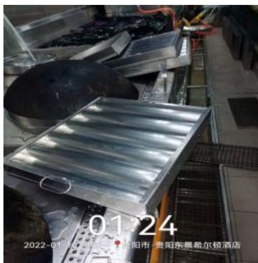
中厨房烟罩清洗后 4
