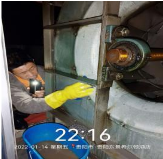
楼顶风机清洗前 2
