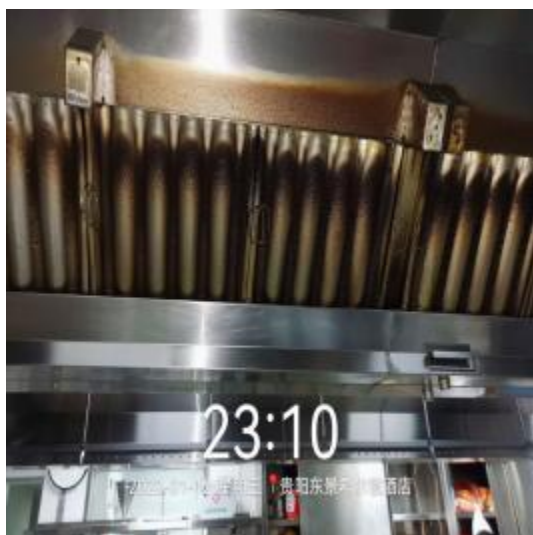
西厨房烟罩清洗前
