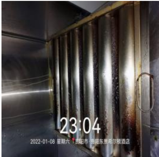
员工厨房防火板清洗前
