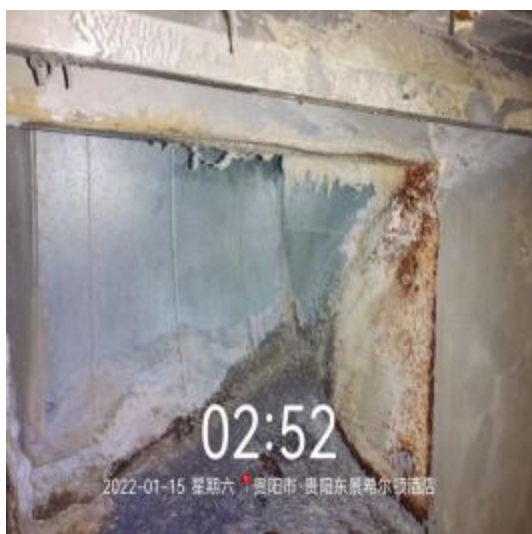
洗衣房管道清洗前
