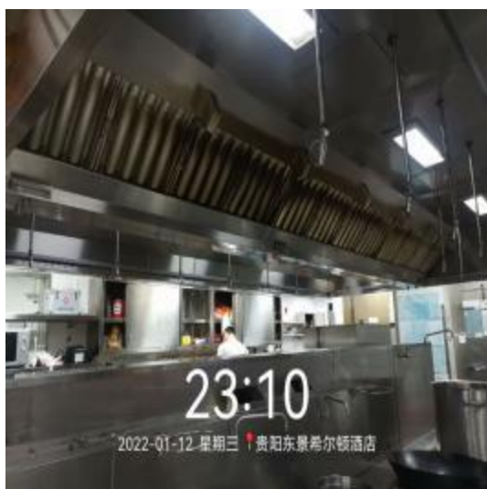
西厨房烟罩清洗前
