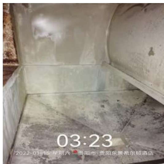
洗衣房管道清洗后
