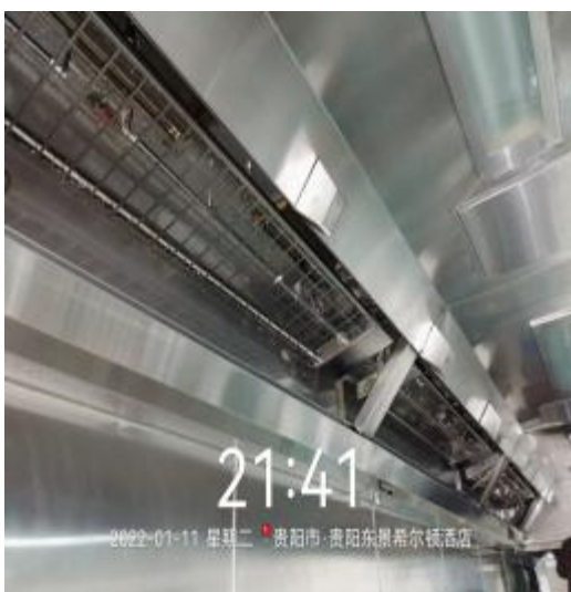
宴会厨房烟罩清洗后
