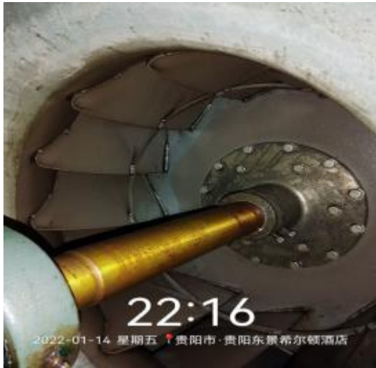
楼顶风机清洗前 1
