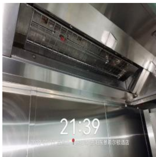
宴会厨房烟罩清洗后 1
