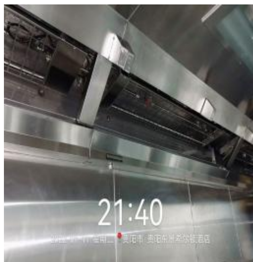
宴会厨房烟罩清洗后 2
