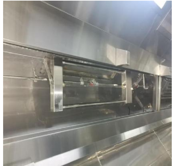
中厨房烟罩清洗后
