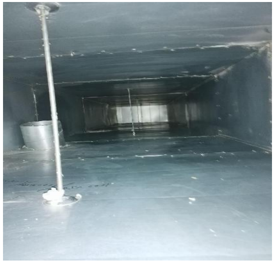
洗衣房管道清洗后 3
