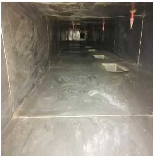
中厨房厨管道清洗后
