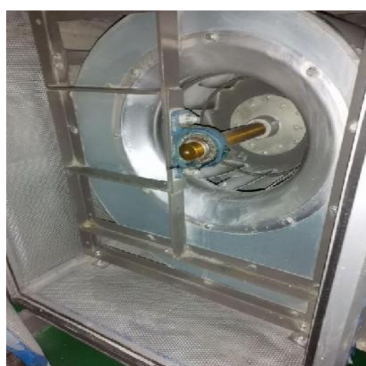
洗衣房风机清洗后
