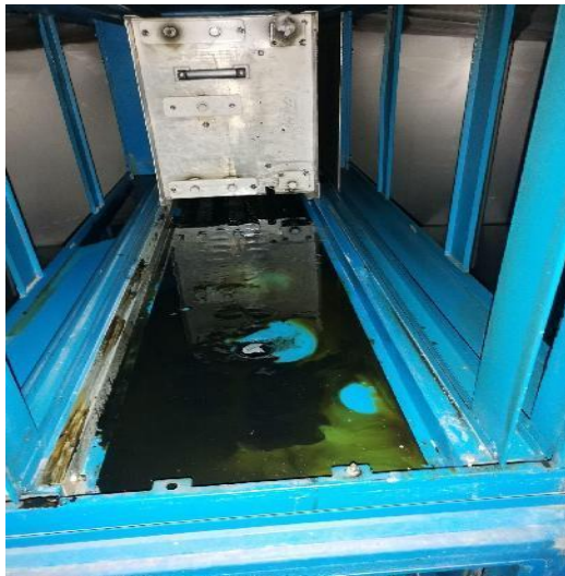
楼顶净化器机箱清洗前
