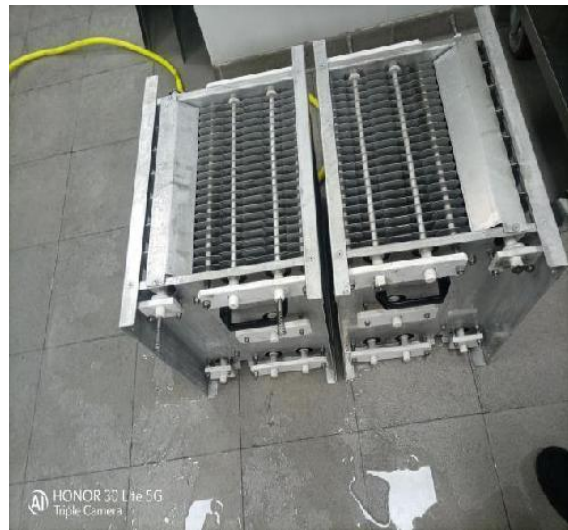
宴会厨房净化器清洗后
