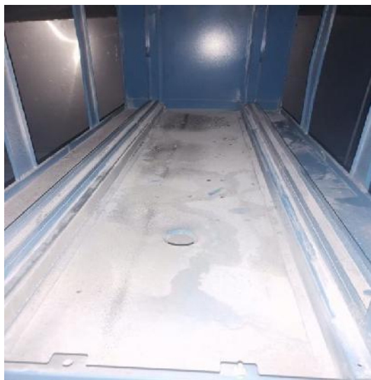
中厨房净化器内部清洗前
