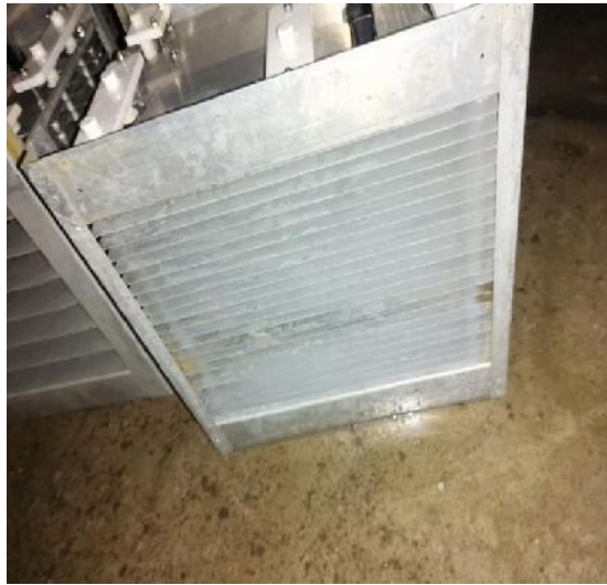
楼顶净化器清洗后
