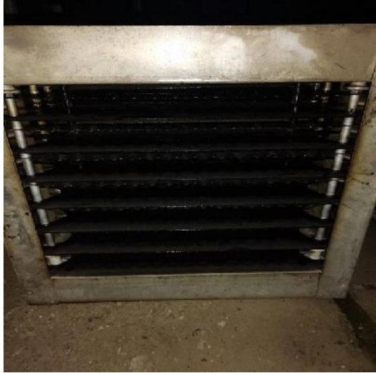
楼顶净化器清洗前
