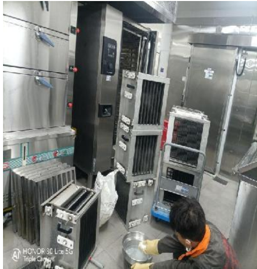
中厨房净化器清洗前中
