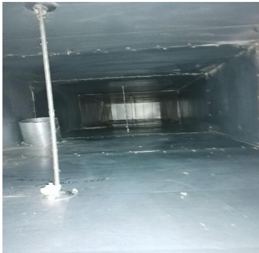
洗衣房管道清洗后 3
