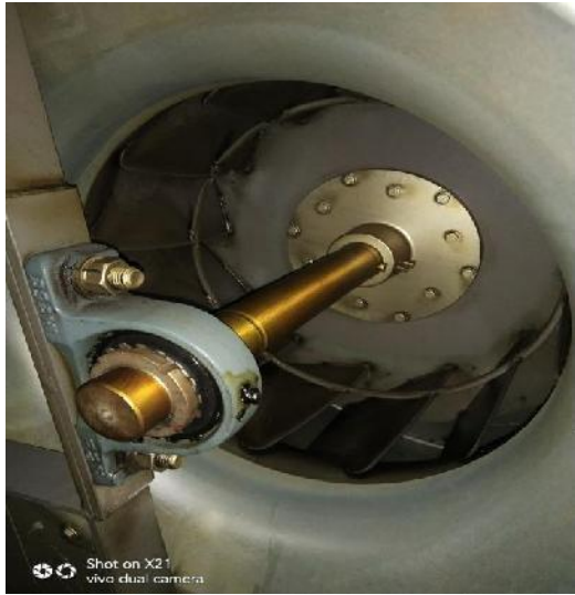
楼顶风机清洗前 1
