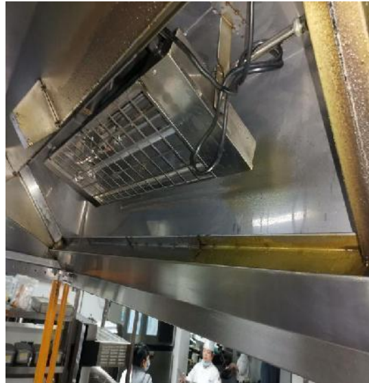
西厨房烟罩清洗前
