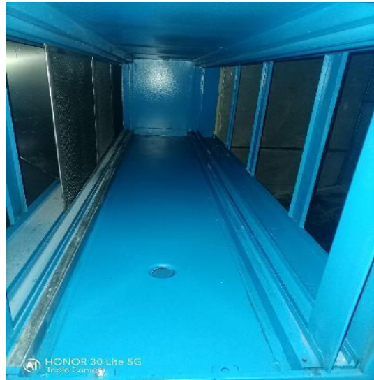
中厨房净化器内部清洗后
