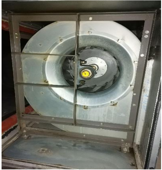
楼顶风机清洗前 2
