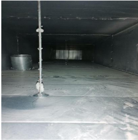
洗衣房管道清洗前 3
