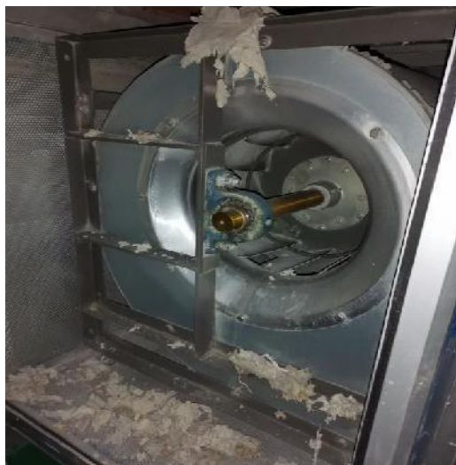
洗衣房风机清洗前
