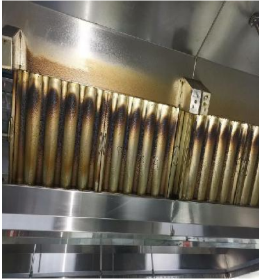
西厨房烟罩清洗前
