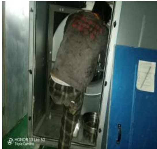
宴会厨房风机清洗中
