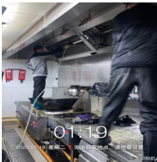
一楼西厨烟罩清洗中
