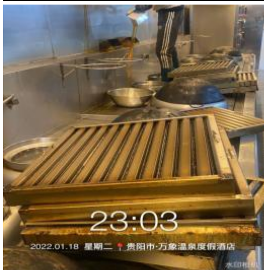
六楼挡板清洗前
