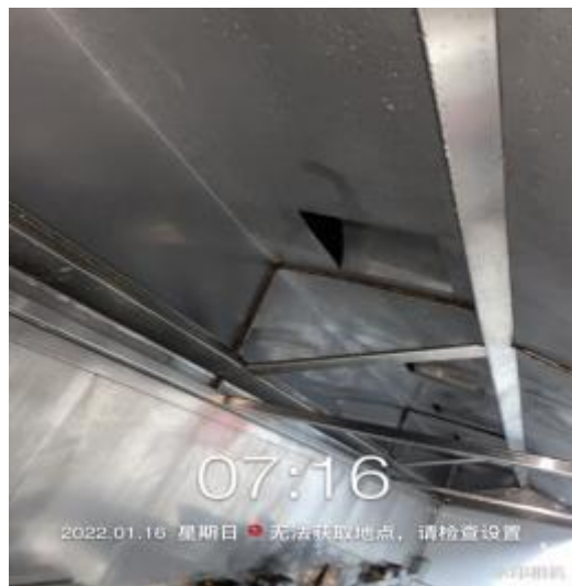
四楼中厨烟罩清洗后
