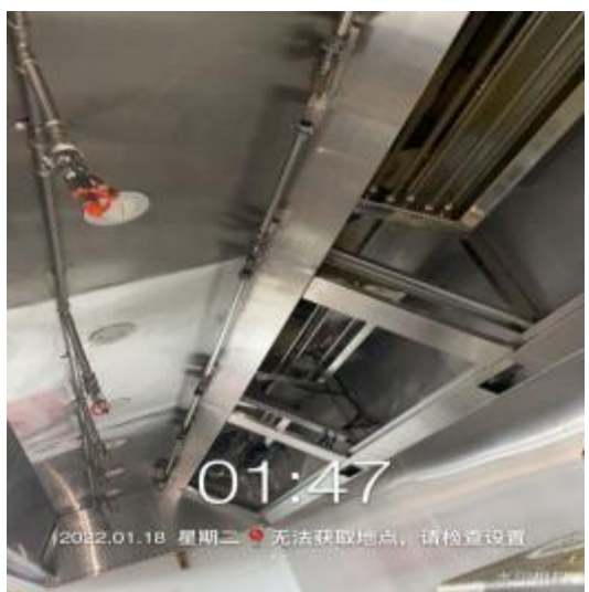
一楼西厨房烟罩清洗后
