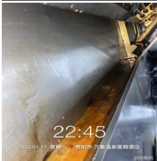
一楼西厨烟罩清洗前
