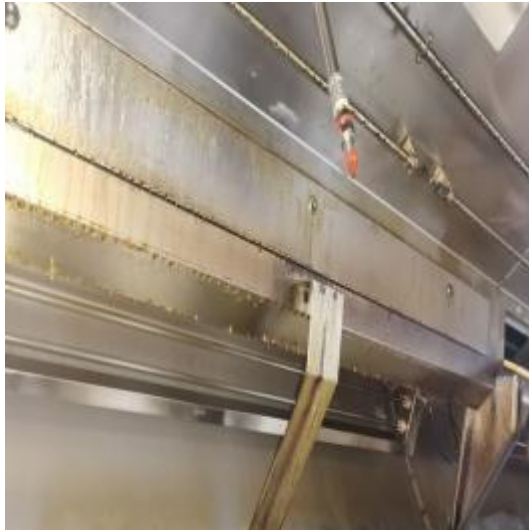
中厨房烟罩清洗前
