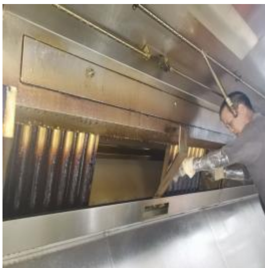
中厨房烟罩清洗中
