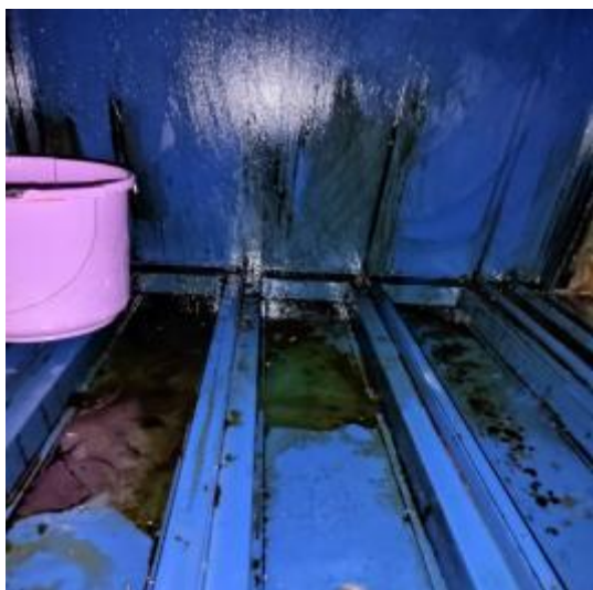
净化器机箱清洗前
