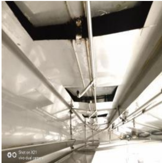
中厨房烟罩清洗前
