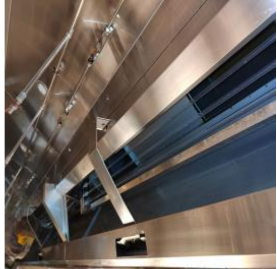
中厨房烟罩清洗前
