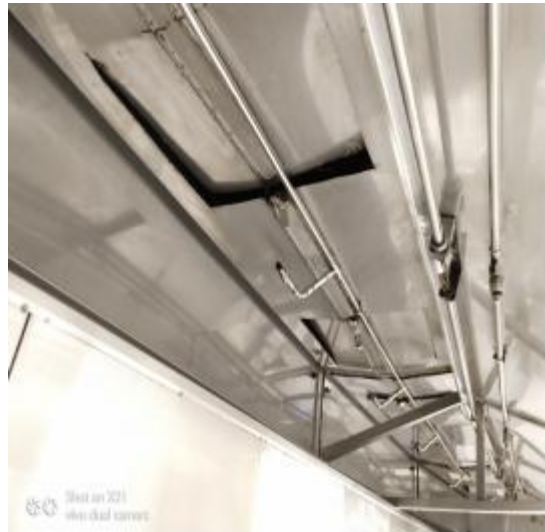
中厨房烟罩清洗后
