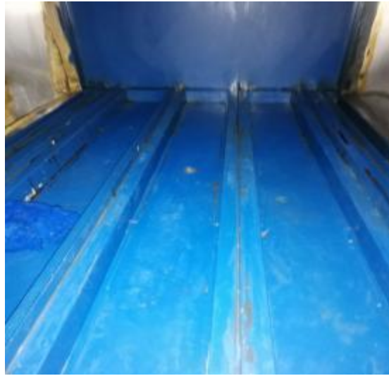
净化器机箱清洗后
