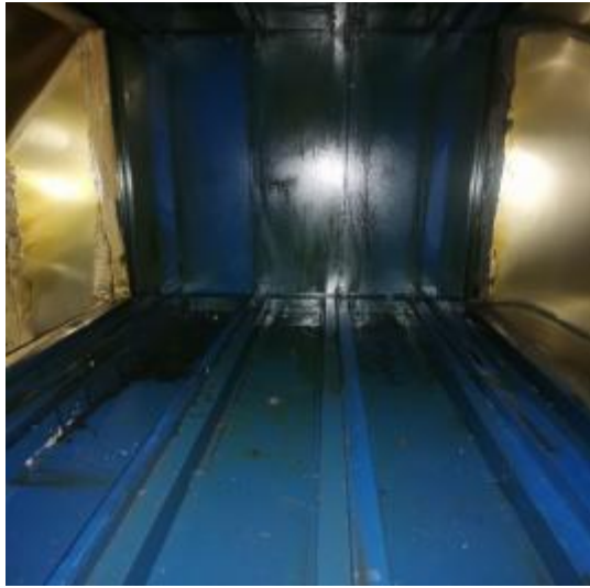
净化器机箱清洗前
