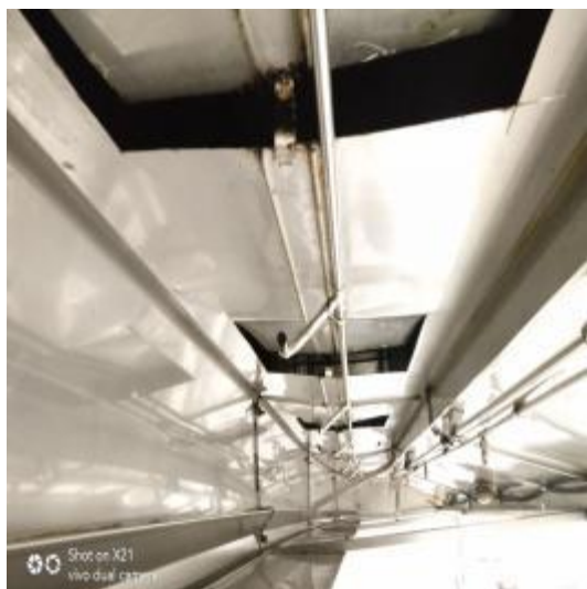
中厨房烟罩清洗前
