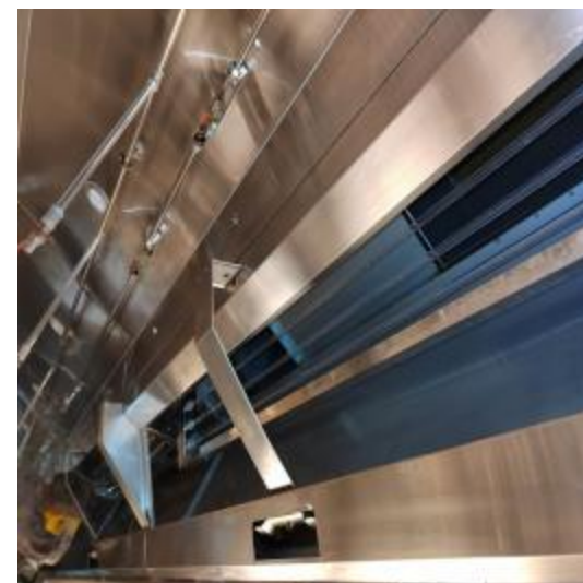
中厨房烟罩清洗中
