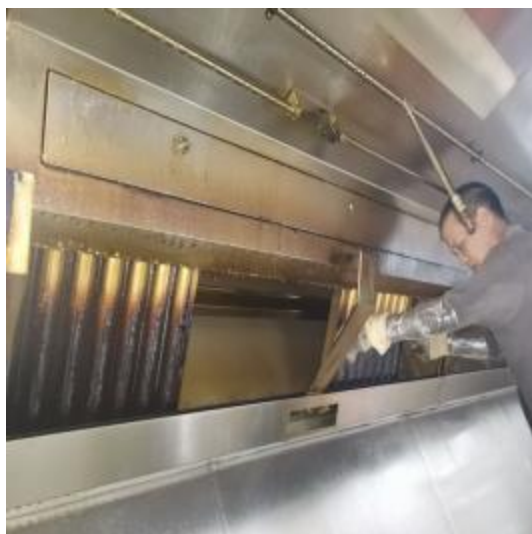
中厨房烟罩清洗中
