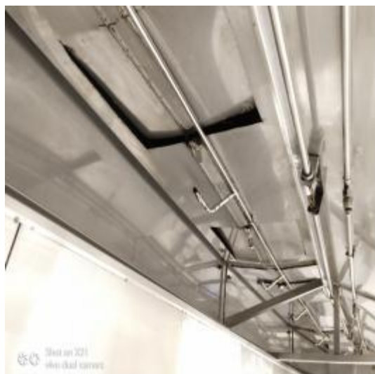
中厨房烟罩清洗后
