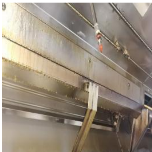
中厨房烟罩清洗前
