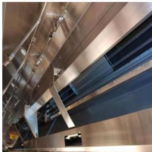
中厨房烟罩清洗前
