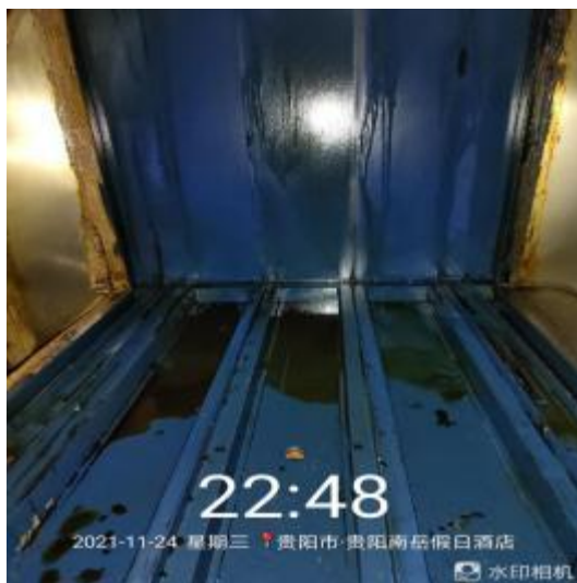
净化器机箱清洗前
