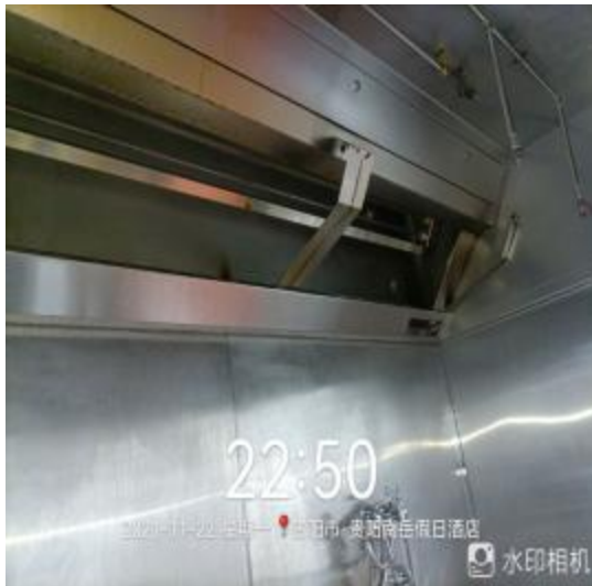
中厨房烟罩清洗前
