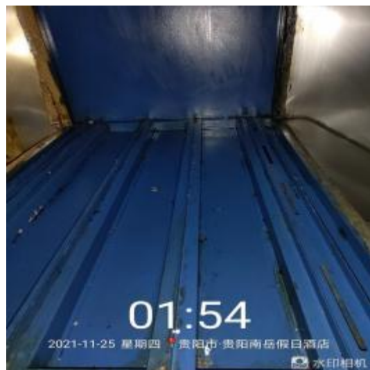
净化器机箱清洗后
