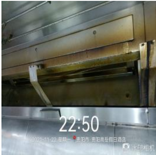
中厨房烟罩清洗前
