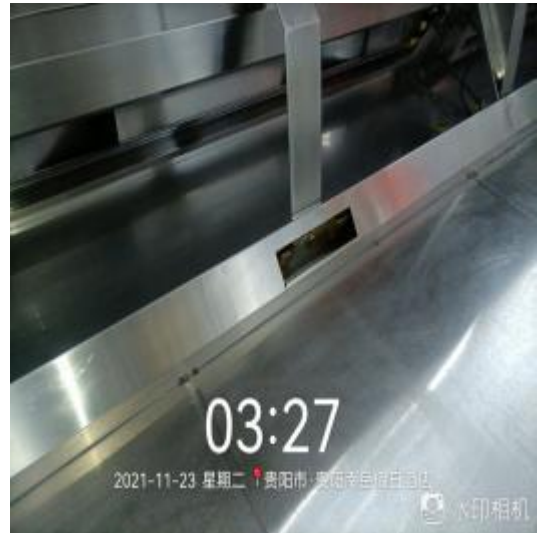
中厨房烟罩清洗前
