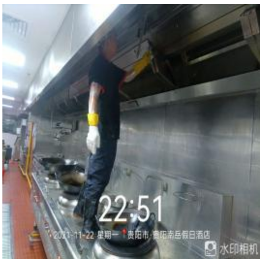
中厨房烟罩清洗中
