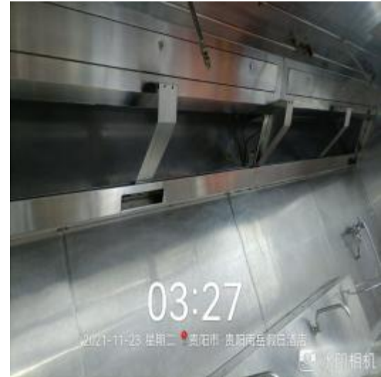
中厨房烟罩清洗后
