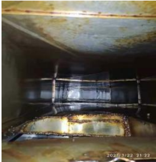
3楼员工厨房管道清洗前
