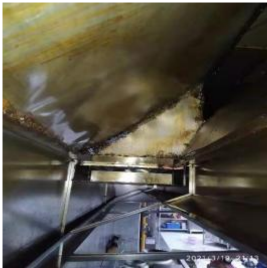
5 楼中厨房烟罩清洗前 2
