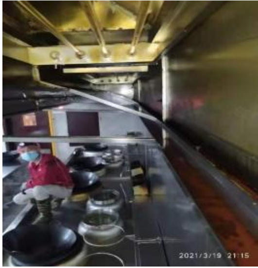
5 楼中厨房烟罩清洗前 1
