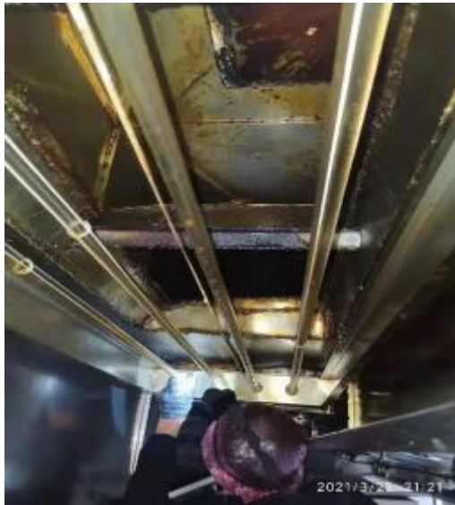
3楼员工厨房烟罩清洗前
