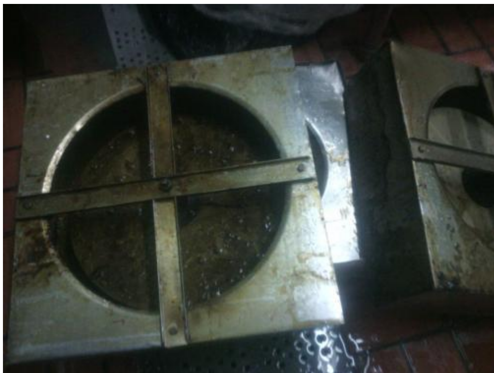
运水风扇清洗前
