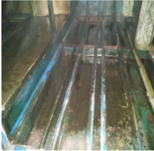
净化器内部清洗前
