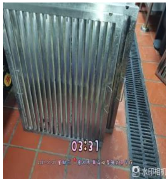
防火板清洗后
