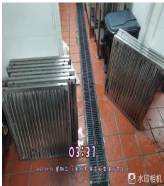
防火板清洗后
