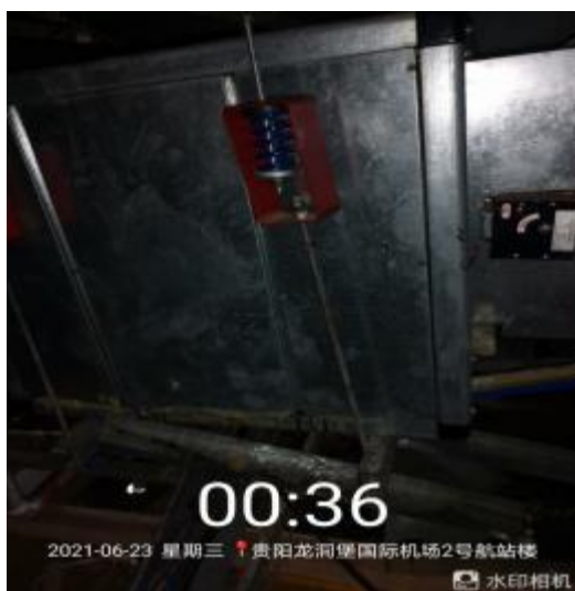
风机机箱清洗后
