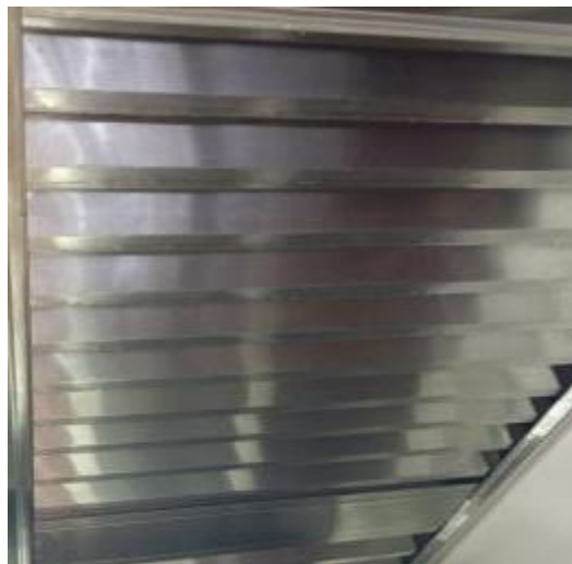
防火板清洗后
