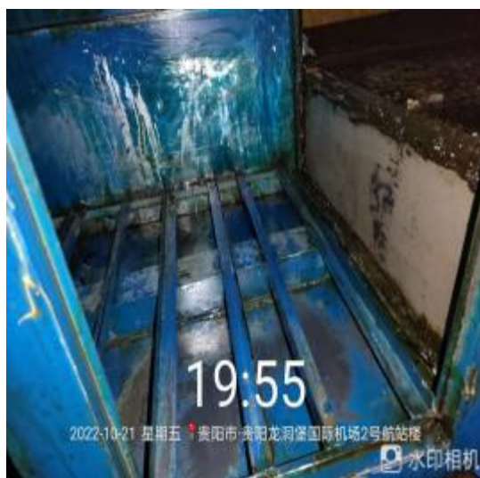
净化器机箱清洗后
