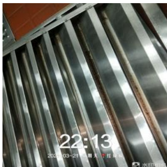
防火板清洗后
