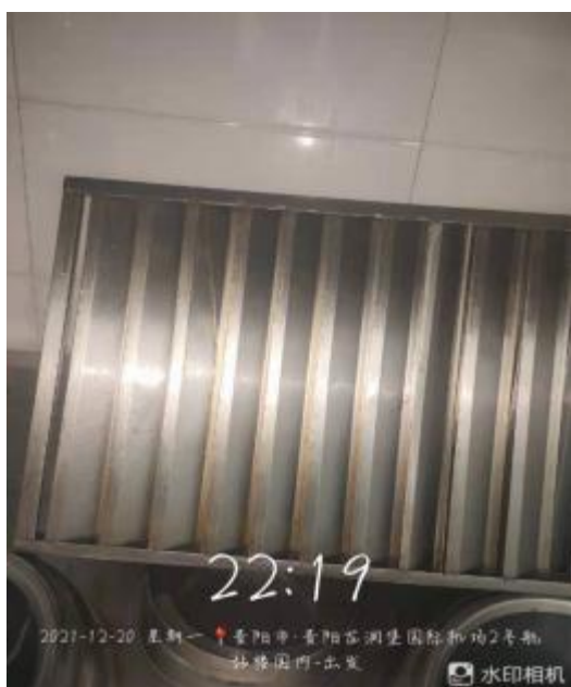
防火板清洗前
