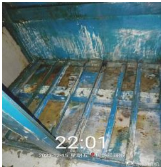
净化器机箱清洗前
