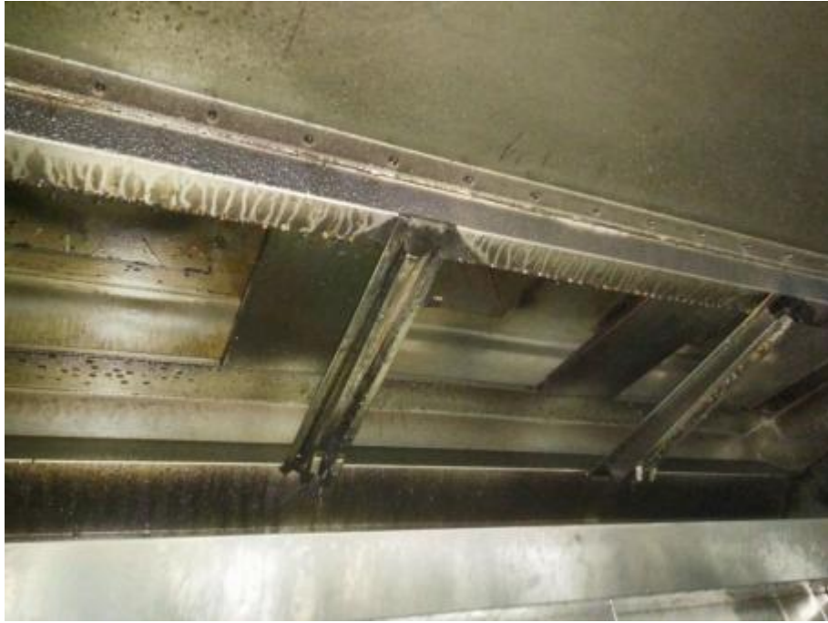
中厨房烟罩清洗前
