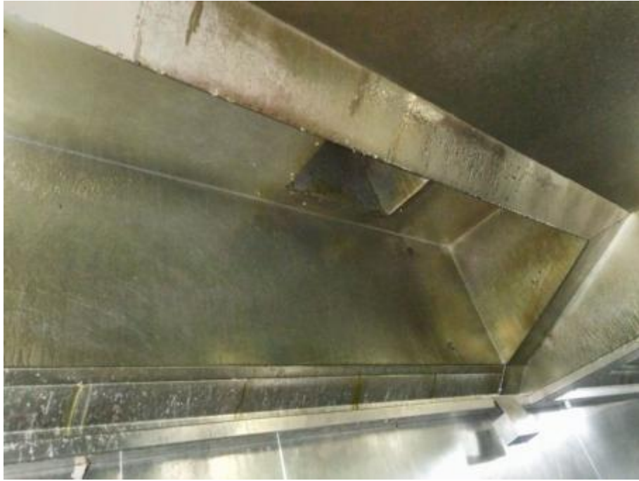
西厨房烟罩清洗前
