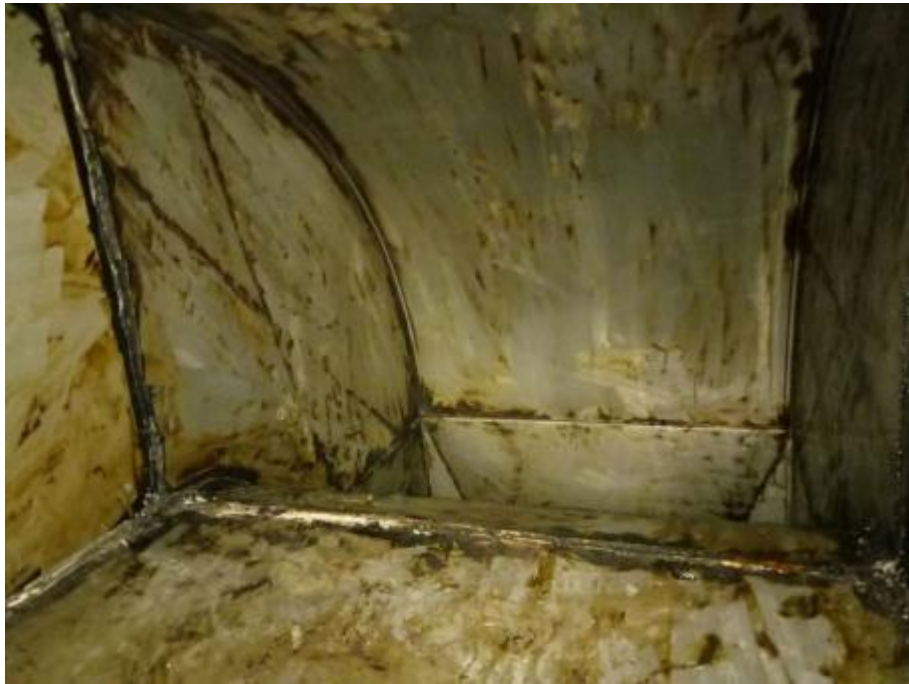
垂直管道清洗后
