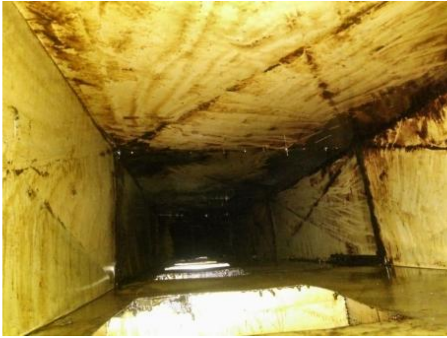
中厨房管道清洗前
