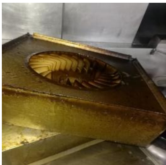
运水风扇清洗前
