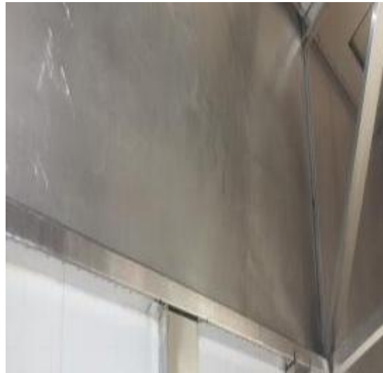
烟罩油槽清洗后
