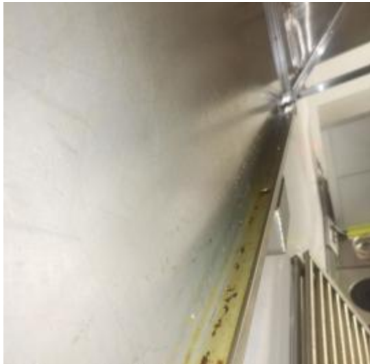
烟罩油槽清洗前
