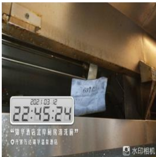
北岸厨房烟罩清洗前
