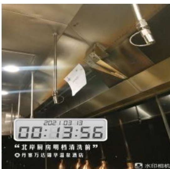
北岸厨房烟罩清洗前
