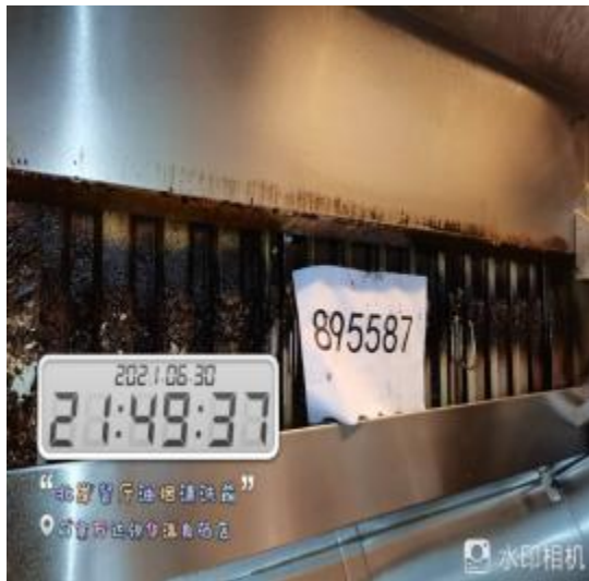
北岸厨房烟罩清洗前 1
