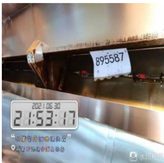
北岸厨房烟罩清洗前 3
