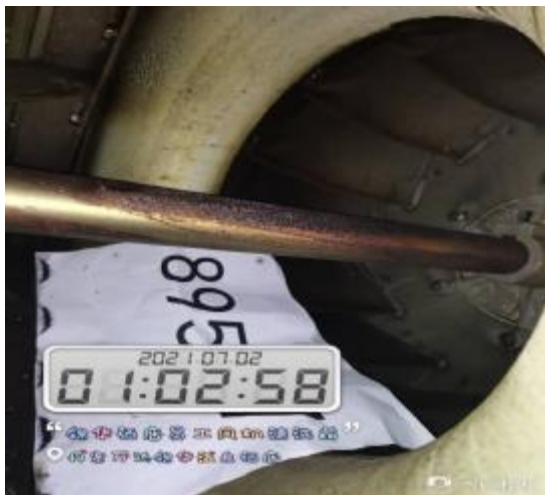
员工厨房风机清洗前
