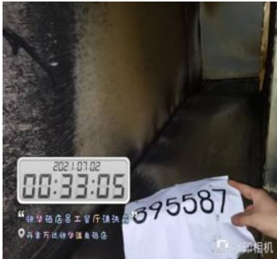
员工厨房管道清洗前
