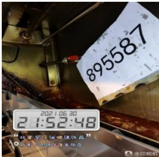
北岸厨房烟罩清洗前 2
