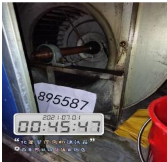
北岸厨房风机清洗前
