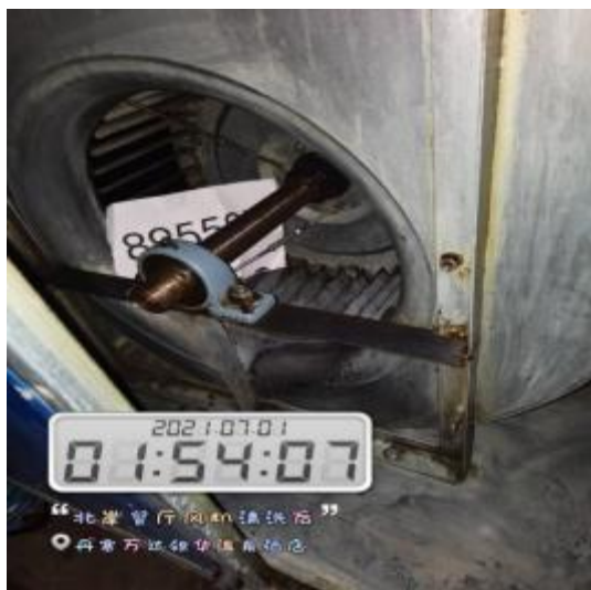
北岸厨房风机清洗后
