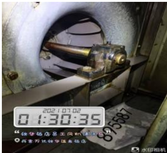
员工厨房风机清洗后
