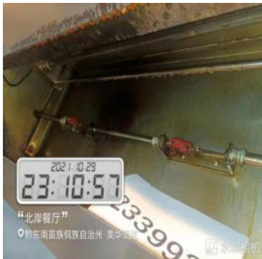
西厨房烟罩清洗前
