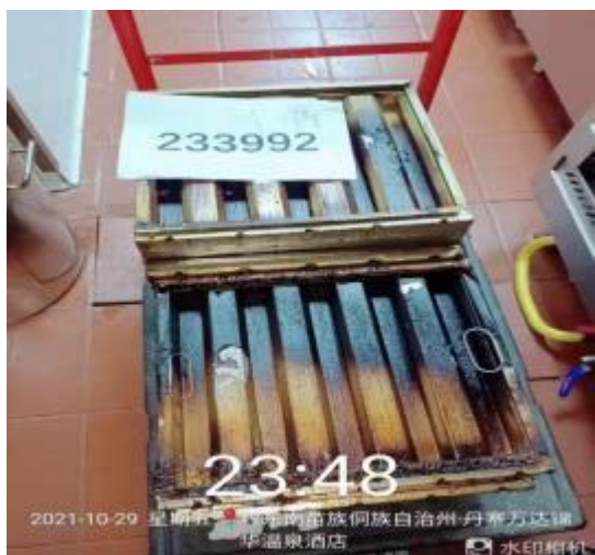
员工厨房防火板清洗前
