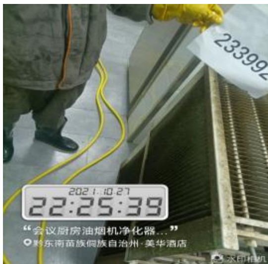
会议厨房净化器清洗前
