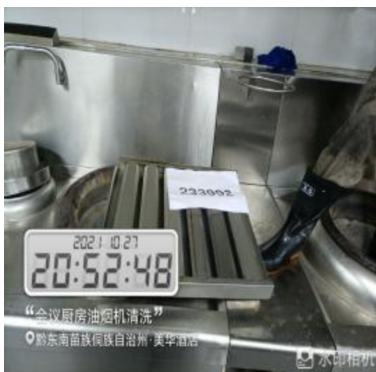
会议厨房防火板清洗前
