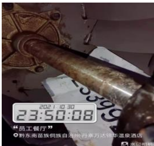
员工厨房室外排风机清洗前
