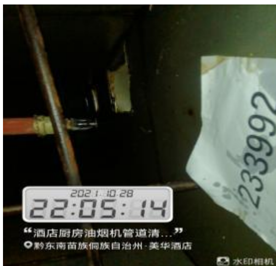
云府餐厅厨房管道清洗前
