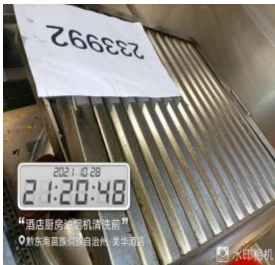
云府餐厅厨房防火板清洗前
