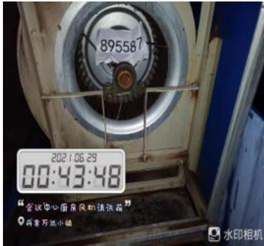
会议厨房风机清洗前
