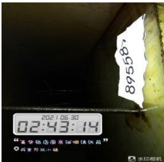
会议厨房管道清洗前
