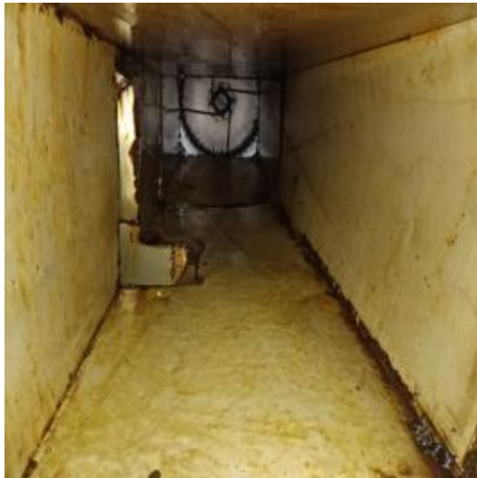
管道风机清洗前
