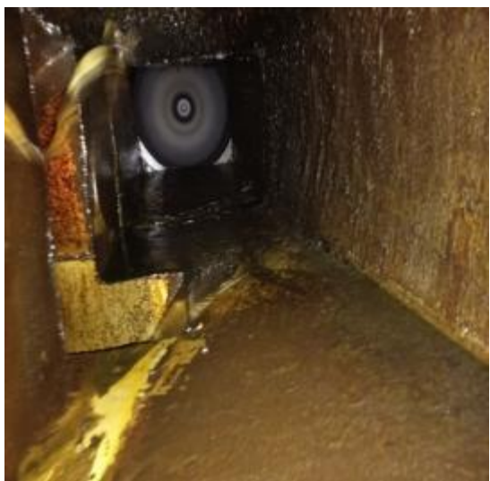
管道风机清洗前
