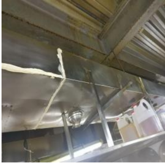
新风管外观清洗前 2
