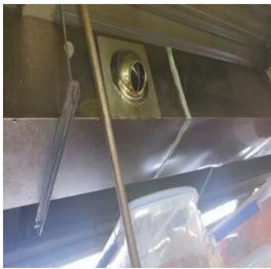
新风管外观清洗前 1
