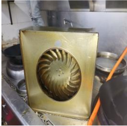
运水风扇清洗前
