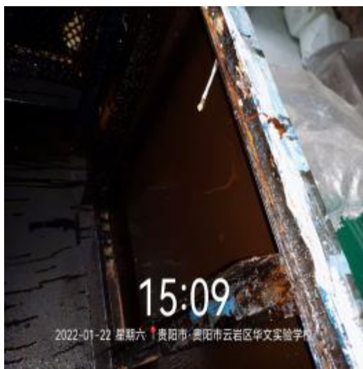
净化器机箱清洗前
