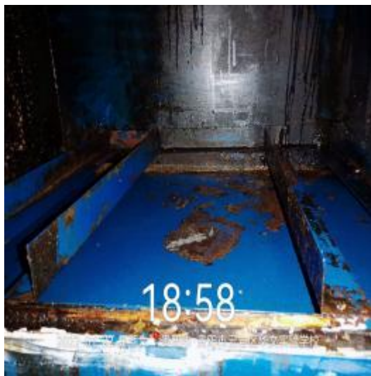
净化器机箱清洗后
