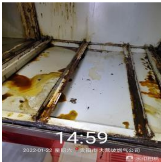
净化器机箱清洗前
