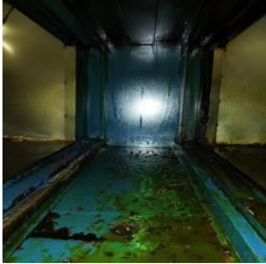
净化器机箱清洗前
