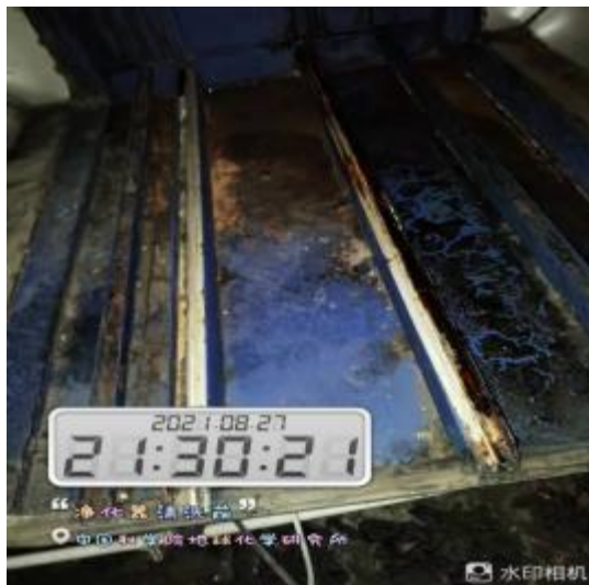
净化器机箱清洗前
