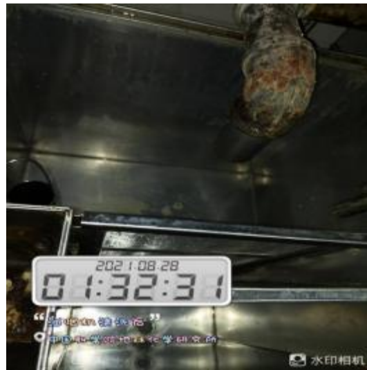
运水控制箱清洗后
