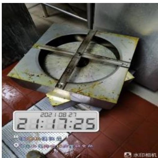
运水风扇清洗前
