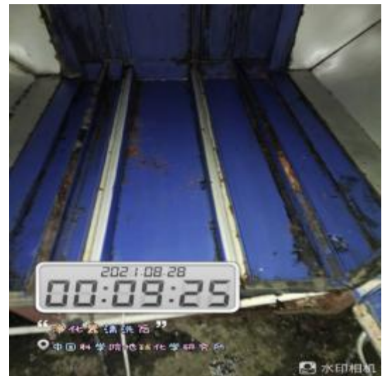
净化器机箱清洗后
