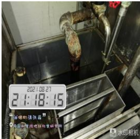
运水控制箱清洗前
