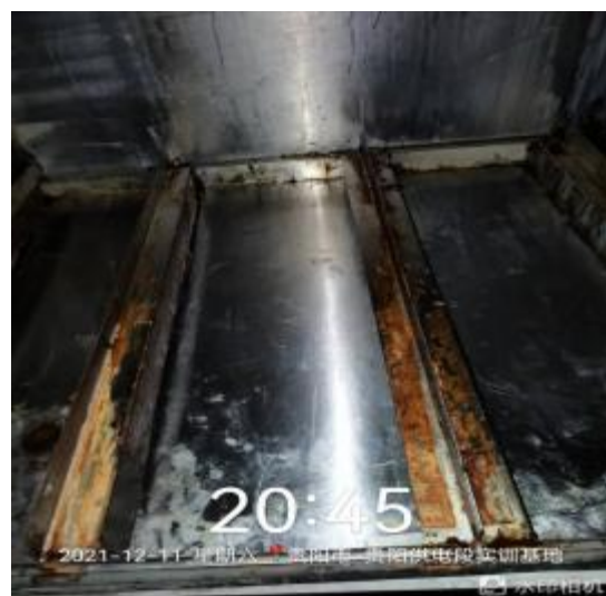
净化器机箱清洗后
