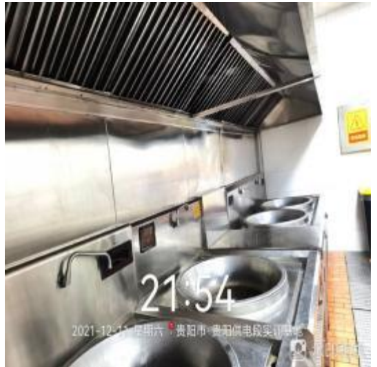
厨房灶台清洗后
