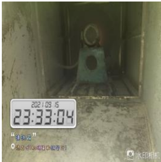
管道风机清洗前
