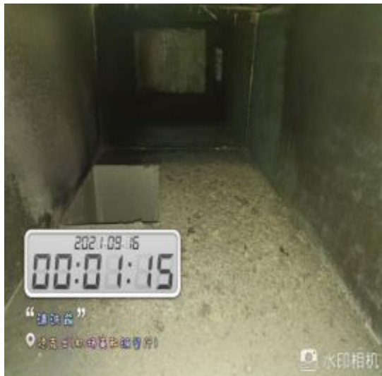
烟罩管道清洗前
