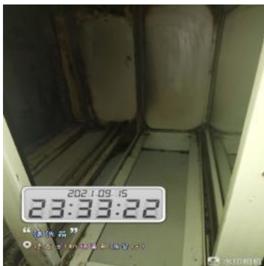
净化器机箱清洗前
