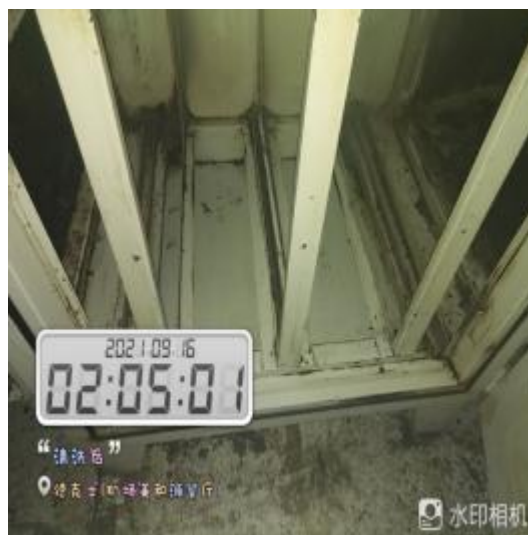
净化器机箱清洗后
