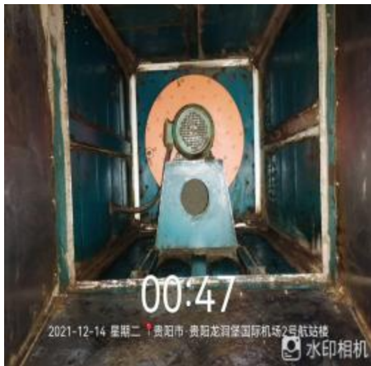
管道风机清洗前
